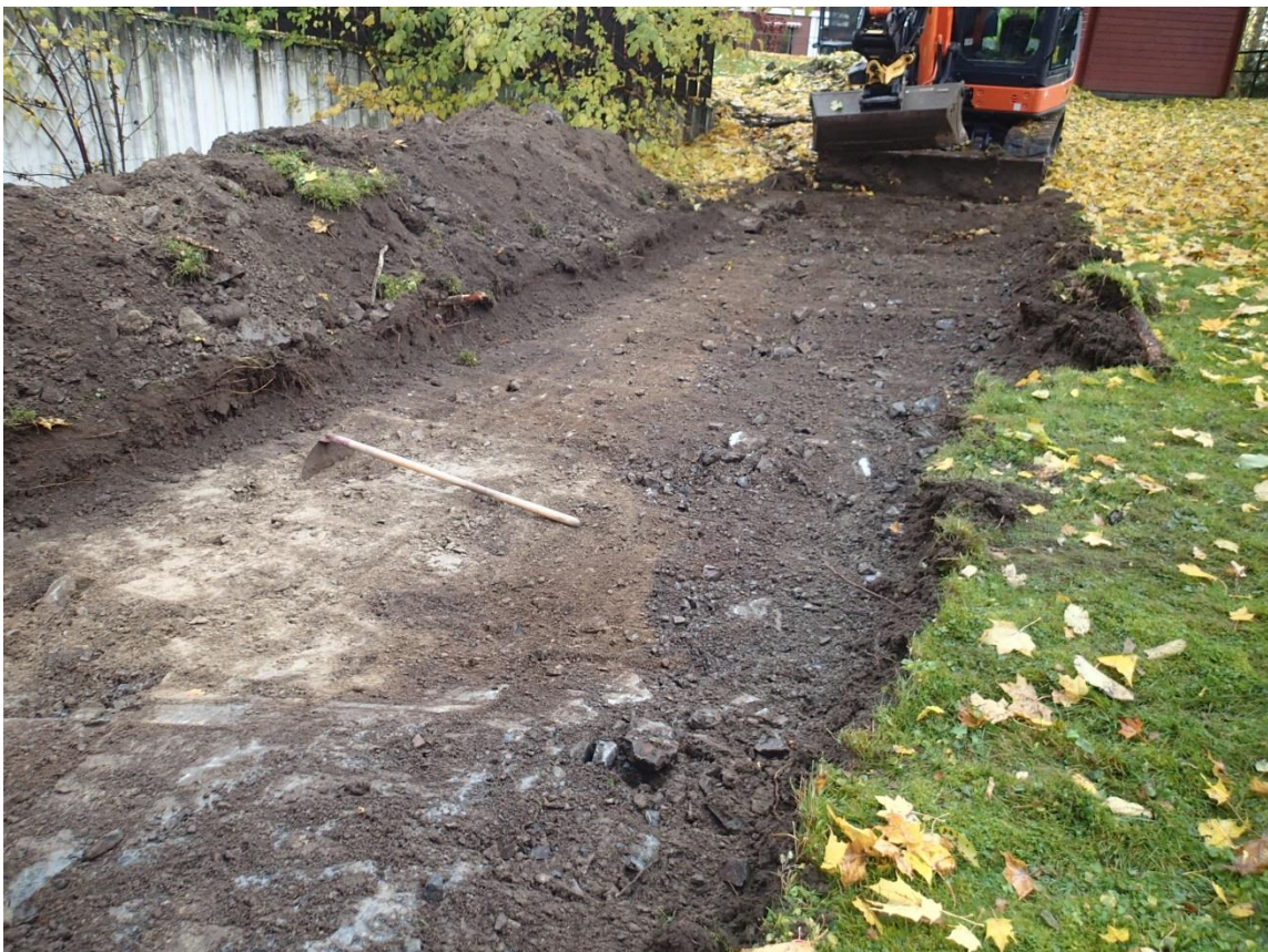
Figur 73 - Naturlig undergrunn i overgangen mot grunnfjell i E2. Bilde tatt mot sørøst. Foto: Byantikvaren.
