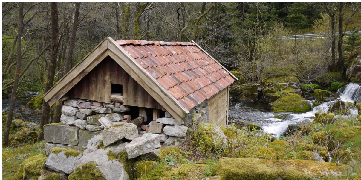
11020031108: Bekkekvern og -sag i tilknytning til gårdsbruk er spesielt utsatte bygninger, på grunn av funksjonstømming. Dette kvernhuset i Sandnes er fint istandsatt. Foto: J. Sognnæs/NIKU 2012
