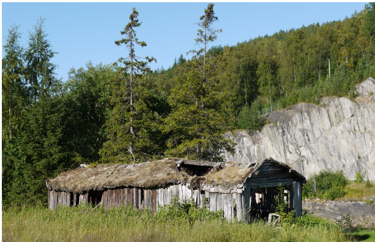
18400206012: En forlatt bygning kan bli stående lenge til forfalls, særlig i utmarksområder, hvor bygningsforfallet er til mindre sjenanse enn i tettbygde strøk. Foto: Å. Dammann/NIKU 2012
