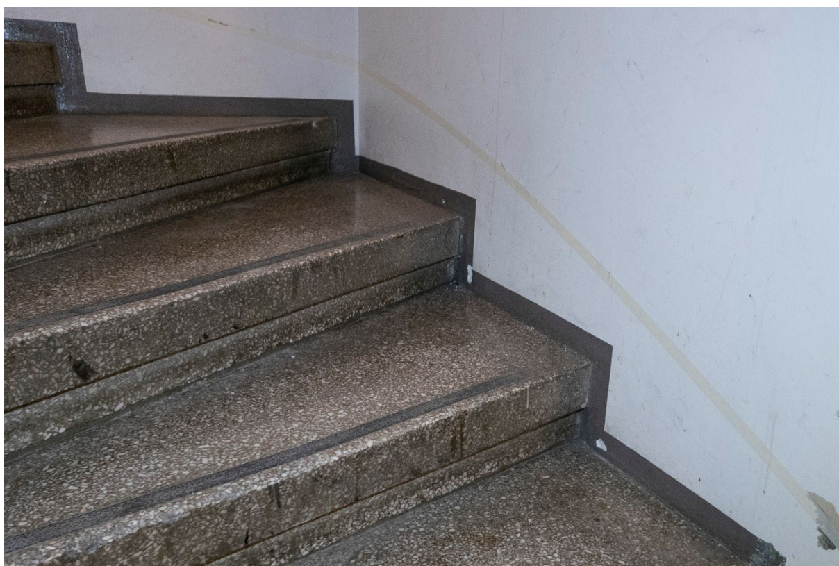
Figur 59 Malt feielist i trappen i rom 025. «Knekk» over hvert trinn. Foto: NIKU, 2023.
