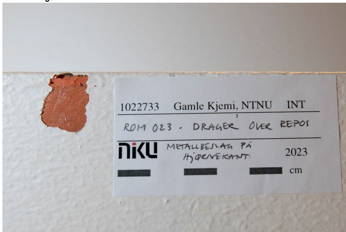
Figur 19 Rom 023. Avdekking av første malingslag på drager over trappen. Laget er også funnet på stålbjelkene mellom buene i kappehvelv i bygningen. Dette er antatt å være rustbeskyttende maling med blymønje og/eller rød jernoksid. Foto: NIKU, 2023.
