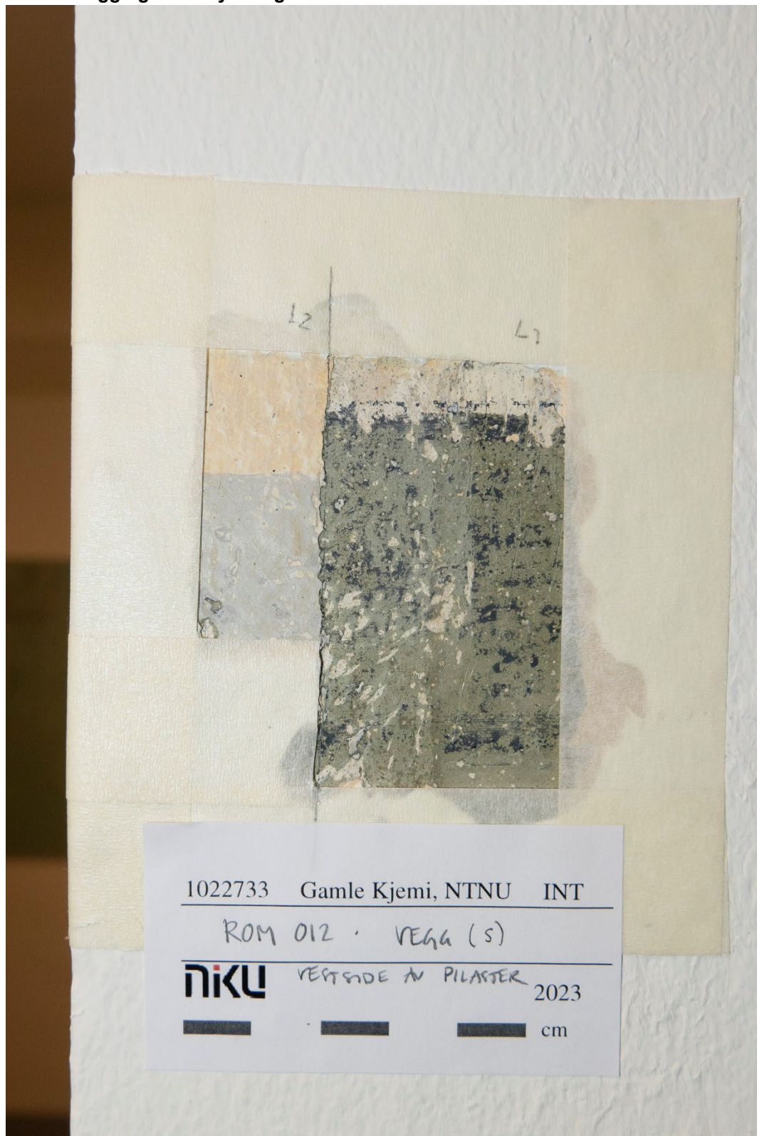
Figur 14 Rom 012. Avdekking av tidligere malte brystninger på pilaster på sørveggen. Malingsmaterialet i den opprinnelige grågrønne brystningen er tørt og matt, med synlige luftbobler i overflaten. Det kan være en emulsjonsmaling. Trolig flere lag som har stått framme mellom lagene som er markert som L1 og L2. Foto: NIKU, 2023.
