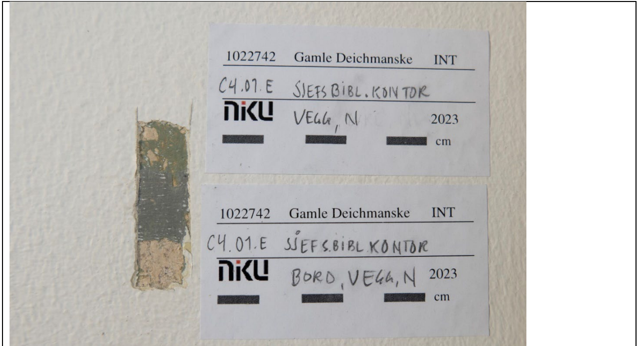
Figur 11 Vegg og malt omramming som har fulgt brystning, hjørner og dør- og vindusgerikter. Oljemaling. Veggens grågrønn. Omrammingen grå. Foto: NIKU, 2023.
