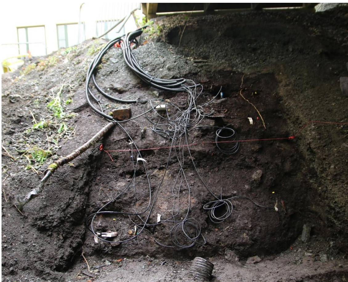
Figur 4: Målesensorer installert i miljøprofil 1. Ledninger ble trukket i rør lagt i grunn grøft vestover mot nabotomten som sees i bakgrunnen på bildet. Sett mot vest. Foto: Da64649_0005.
