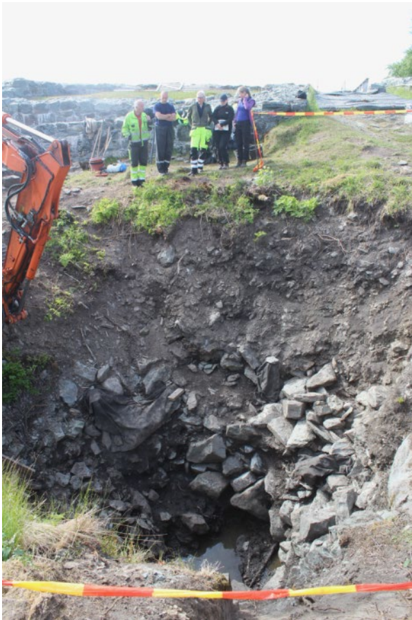
Figur 3 Brønnforsenkingen 13.06.2016 etter utgraving fra overflaten og ned til berggrunnen. Som fotoet viser ligger det fremdeles igjen store rivningsmasser av stein hvor blant annet en del kvadersteiner inngår. På kanten står fra venstre Torstein Opheim, Thomas Andresen, Anna Petersén, Hanne Haugen og Linn Paasche. I bakgrunnen sees ruinene etter bygningskomplekset i sør. (Foto RM\NIKU, mot sør).
