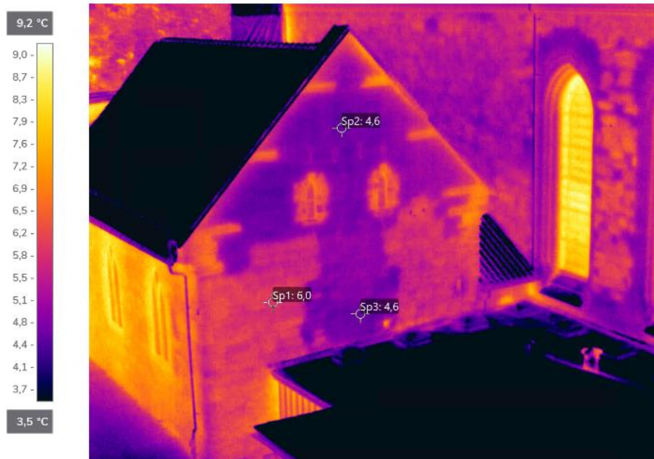
Figur 17. Temperaturforskjeller i vestveggen i en mindre bygning nord for Domkirken. Figur: J. Causevic. Sett mot SØ
