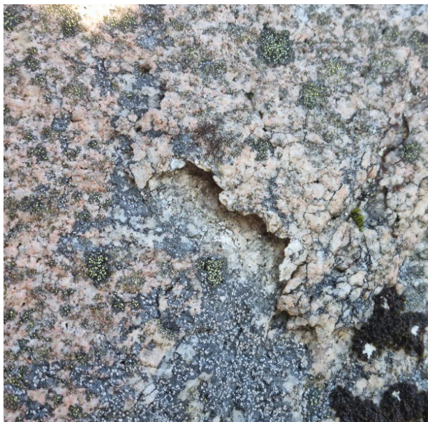
Figur 13 Avskalling og bom i vitringshuden på felt VIII. Løs avskallingskant. Foto: Karen Mengshoel, NIKU.
