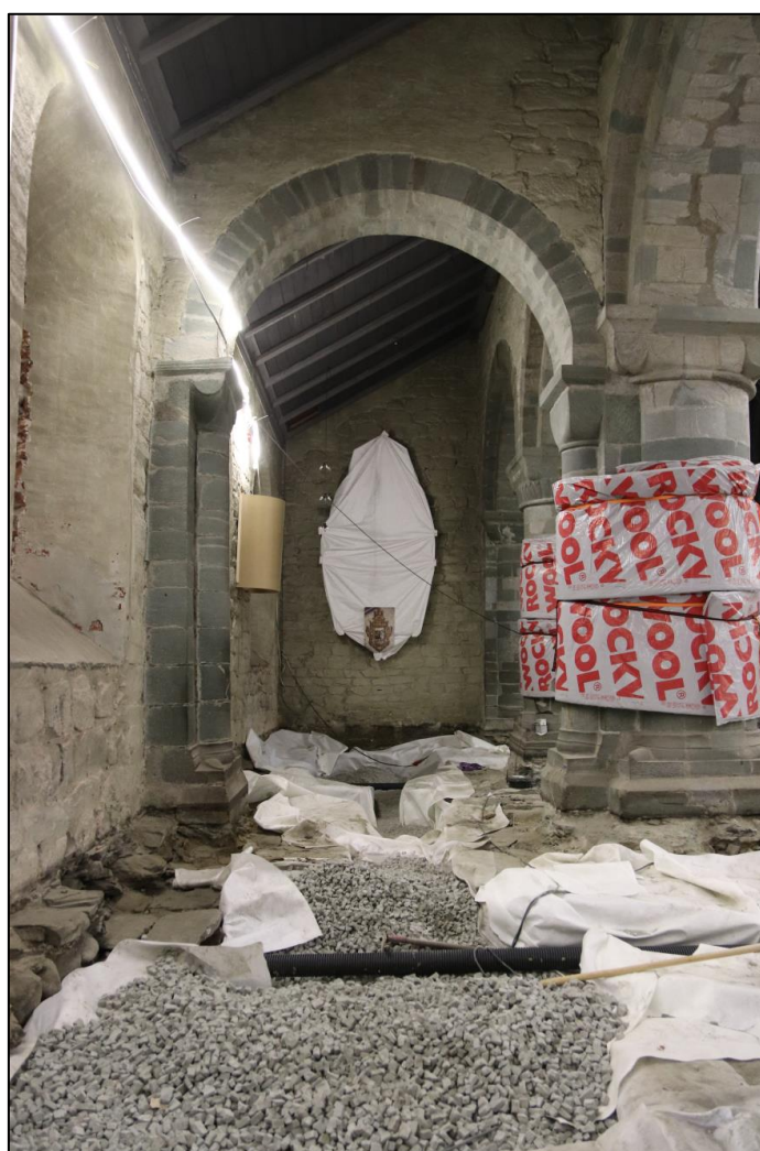
Figur 11: Eksempel på utskifting av masser i Stavanger domkirke, hvor lettere masser (glasopor) ble anvendt til igjenfylling av deler av kirkens krypkjeller. Foto: NIKU prosjekt 1021779, Stavanger domkirke.
