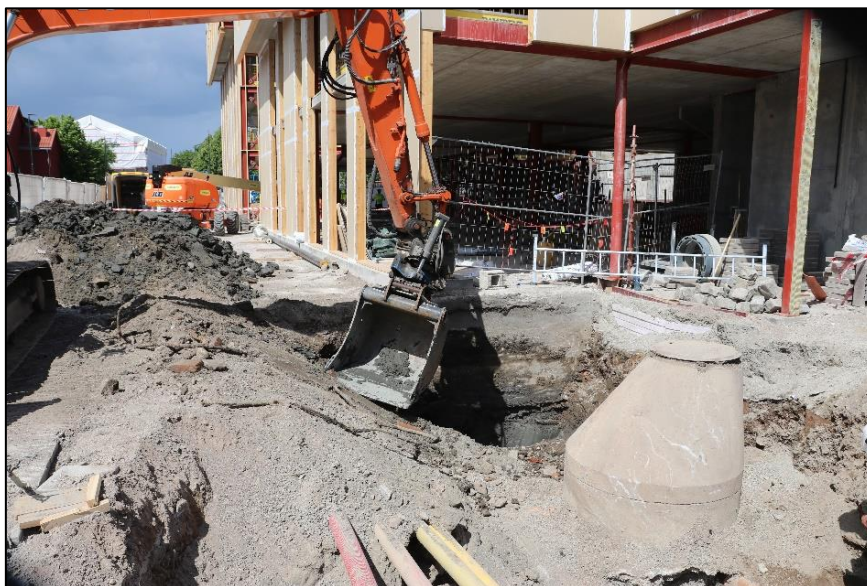
Figur 30 Nedsetting av ny kum ved bygg, i Klostergaten / Nedre Langgate, mot nordvest. Cf54074_NIKU_022.JPG.
