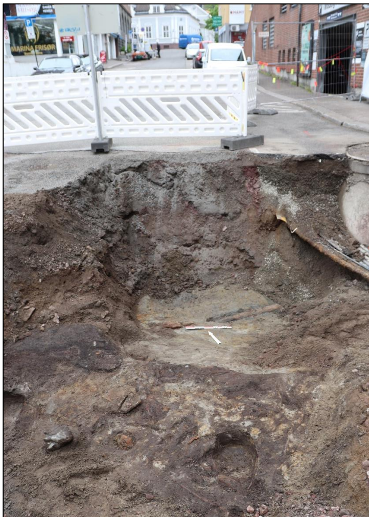
Figur 13 Oversikt hovedgrøft sett mot nordøst, med utvidelse med kulturlag i forgrunn av bildet. Trestokker i bunn av hovedgrøft i bakgrunnen. Cf54074_NIKU_008.JPG.
