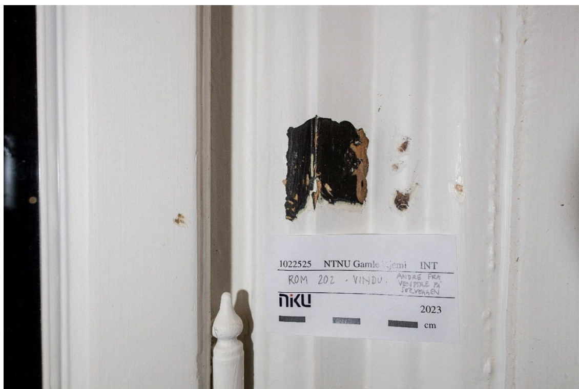
Figur 74 Rom 202. Avdekking av opprinnelig farge på vinduets karm. På de to halvstafflistene mot smyget er det bare hvite lag. I avdekningen ser overflaten mørk ut, men det er på grunn av kvist i treet. Disse er satt inn senere enn karmen og har færre malingslag. Foto: NIKU, 2023.
