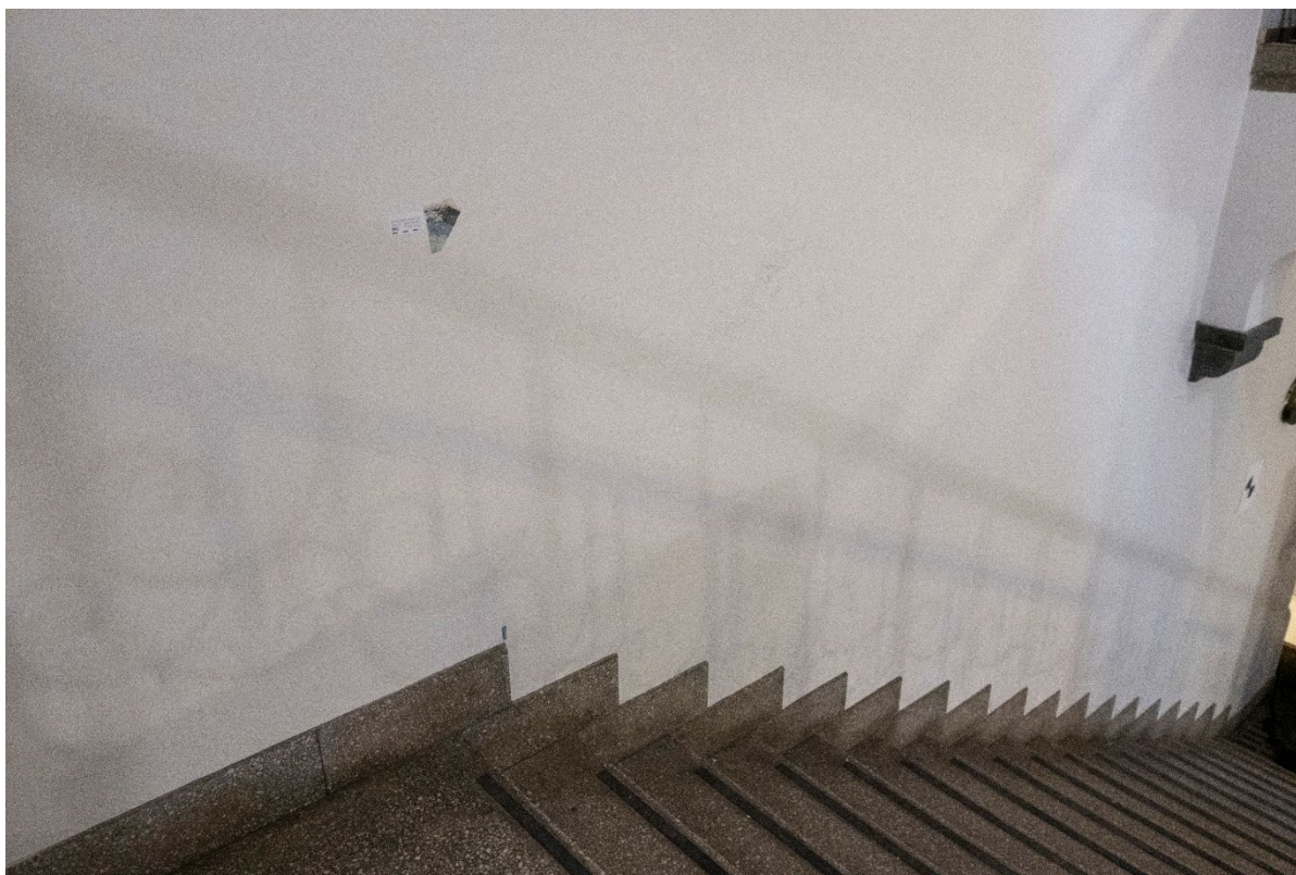
Figur 58 Rom 219. Avdekning for å kartlegge utstrekning av malte brystninger i trappen mellom rom 123 og rom 219. «Knekk» på vegg ligger over overgangen mellom repos og trappetrinn, ca. 113 cm opp fra reposgulvet. Foto: NIKU, 2023.
