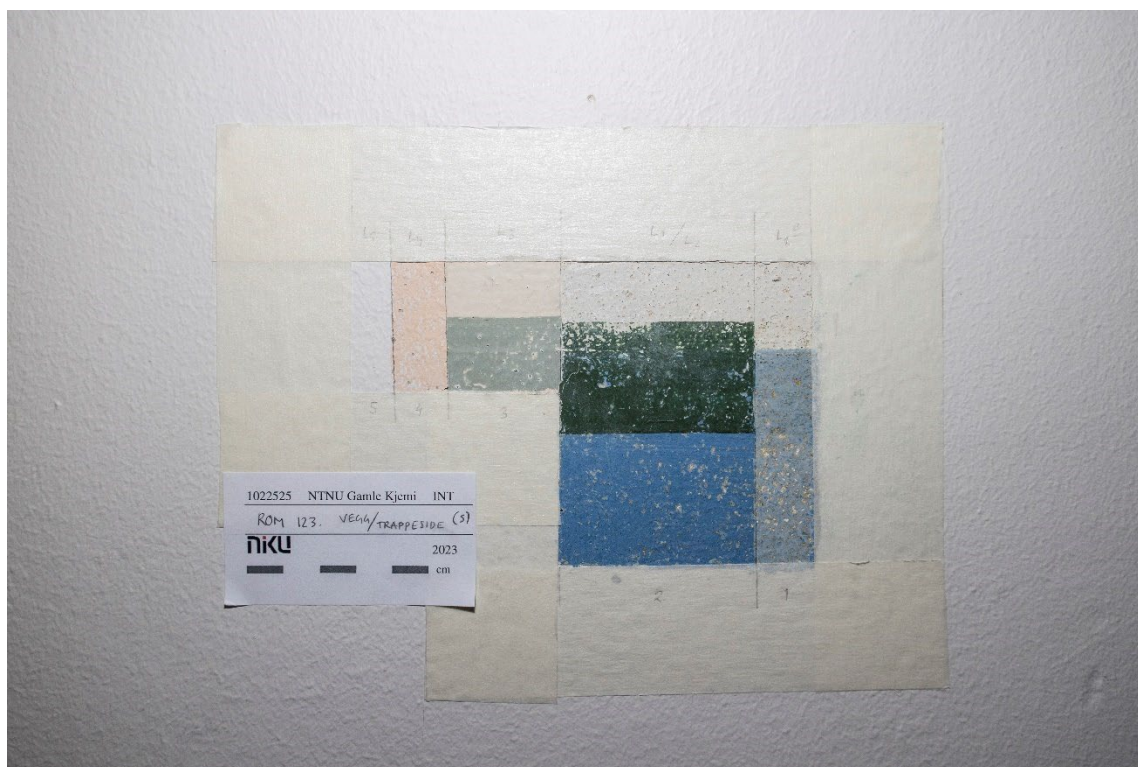
Figur 34 Rom 123. Lagvis avdekking av malingslag på vegg mot sør/siden av trappen opp til rom 219. Foto: NIKU, 2023.
