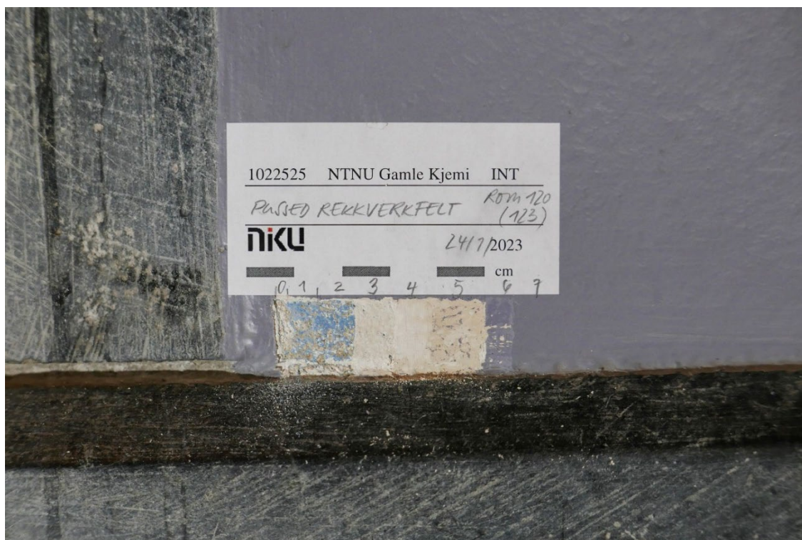
Figur 48 Rom 123. Lagvis avdekking på pusset rekkverk som vender mot nord, mot rom 120. Foto: NIKU, 2023.
