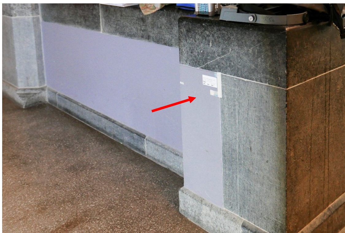
Figur 49 Rom 123. Plassering av avdekking på pusset rekkverk mot sør, mot rom 123 (rød pil). Foto: NIKU, 2023.
