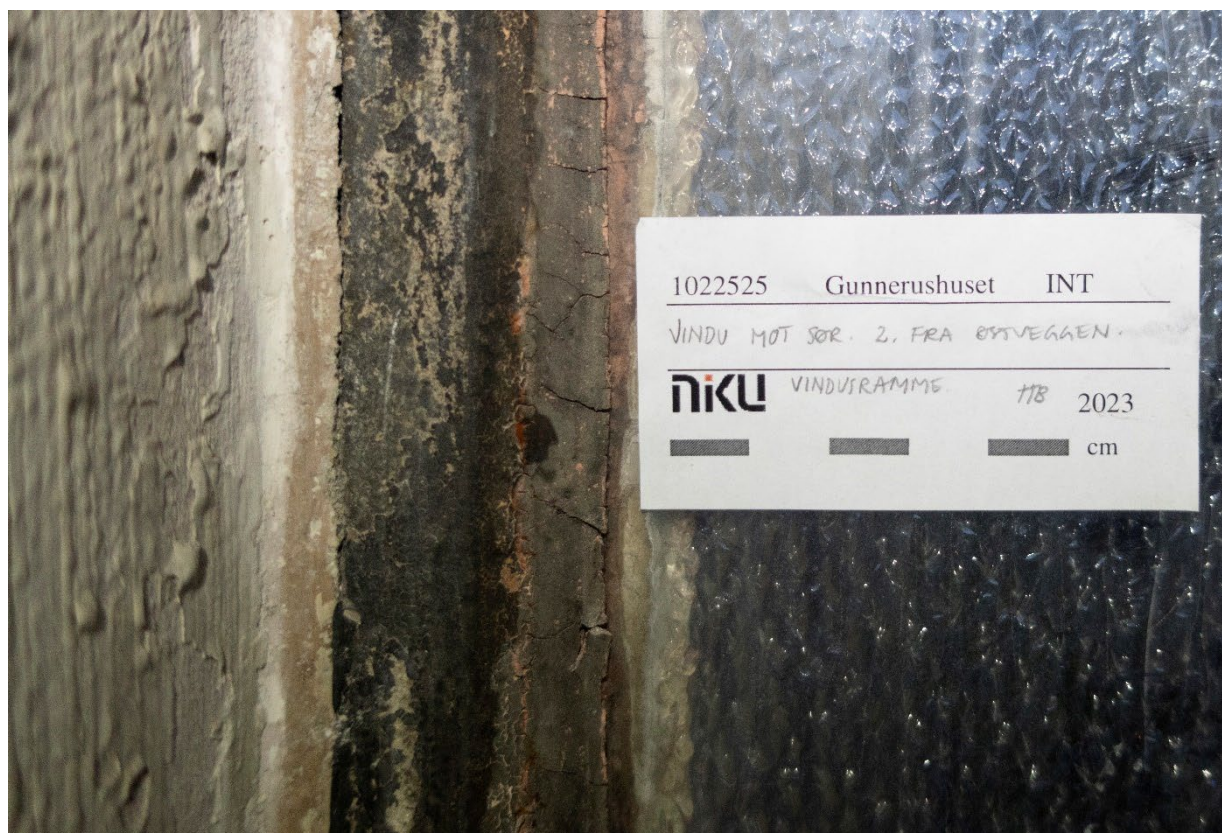
Figur 39 Negativt fargespor etter opprinnelig skillevegg. Umalt felt er ca. 10 cm. Foto: NIKU, 2023.
