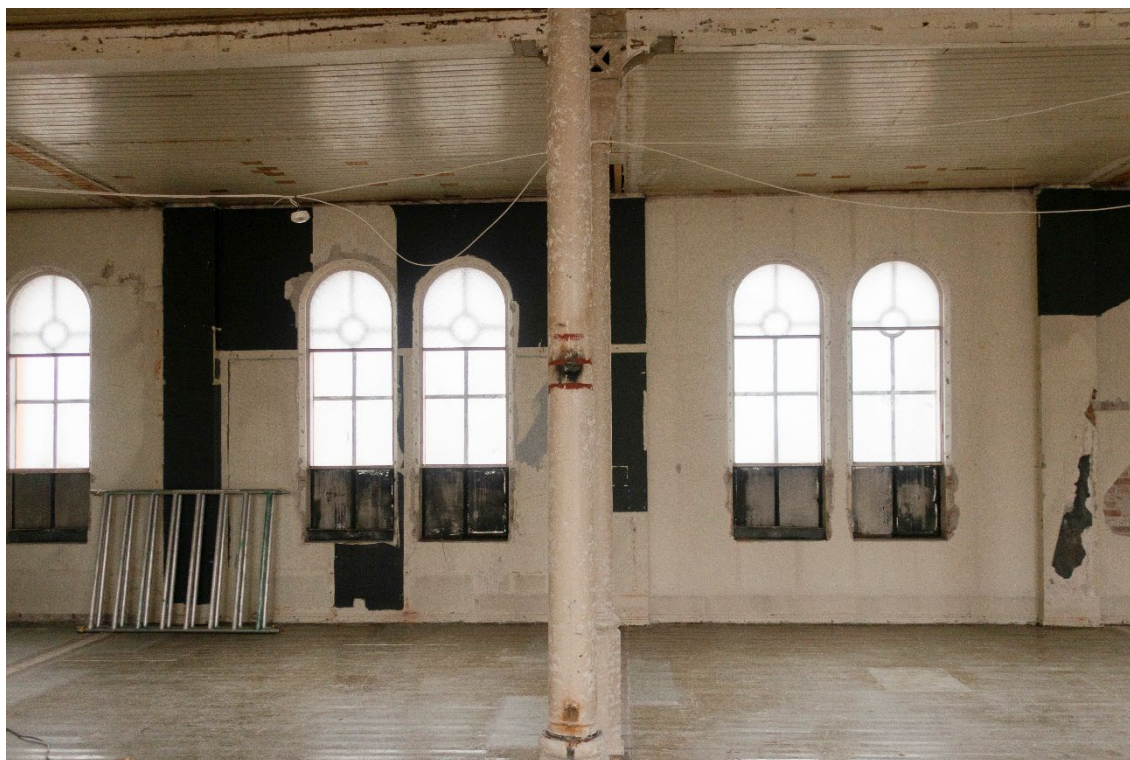
Figur 8 Gunnerushuset. Rom A220. Vegg mot nord. Midtre del. Foto: NIKU, 2023
