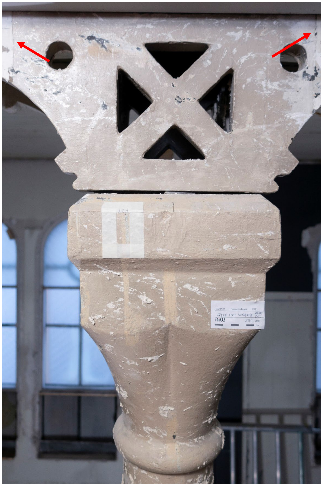
Figur 26 Øvre del av nordvestligste søyle. Negative fargespor etter innbygging markert med røde piler. Gipssøl på overflaten. Foto: NIKU, 2023.
