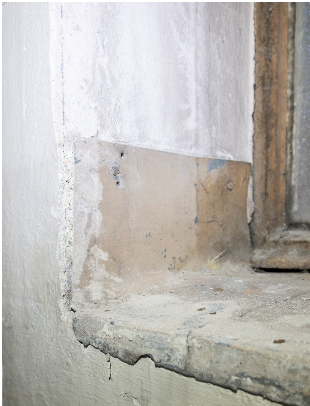
Figur 38 Pusset vindussmyg med beslag i nedre del. Foto: NIKU, 2023.
