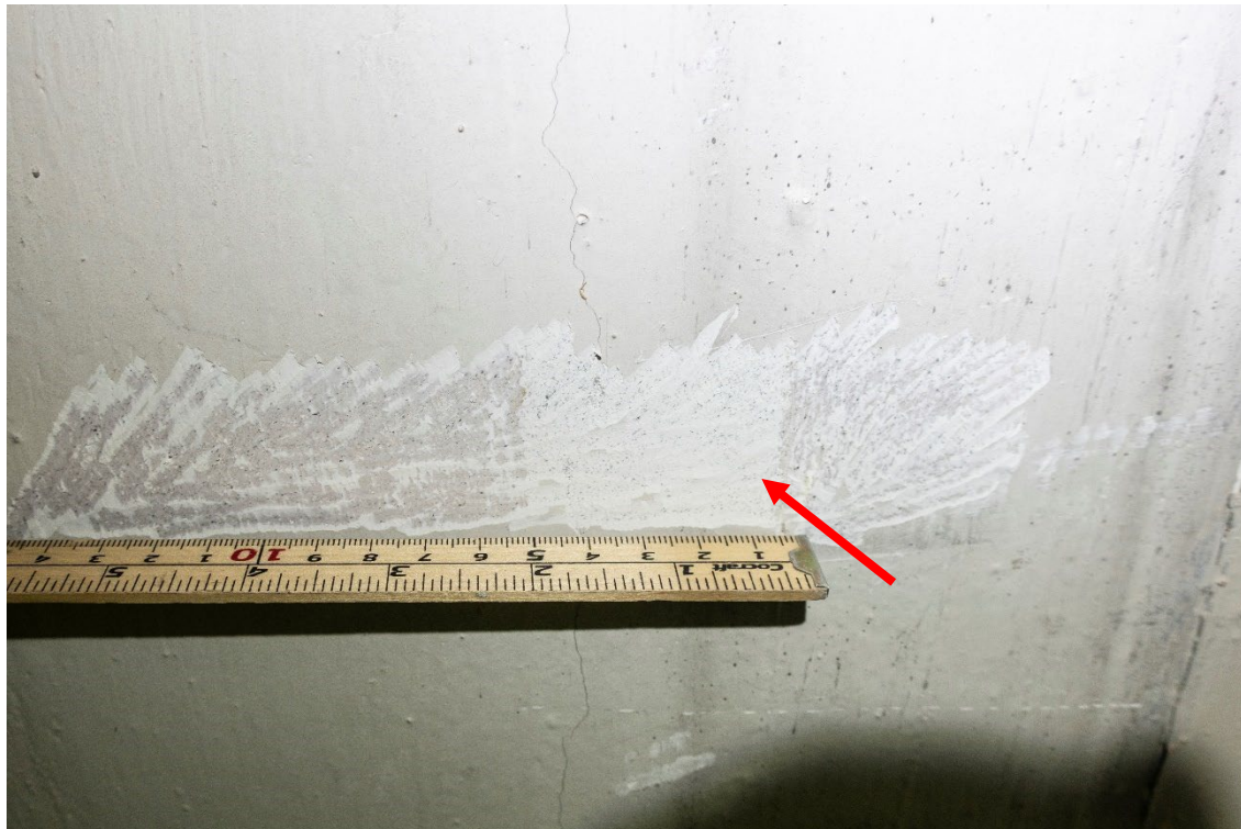
Figur 31 Negativt fargespor etter opprinnelig skillevegger som gikk fra søylene og ut på langveggene (rød pil). Ca. 5 cm bredt. Foto: NIKU, 2023.
