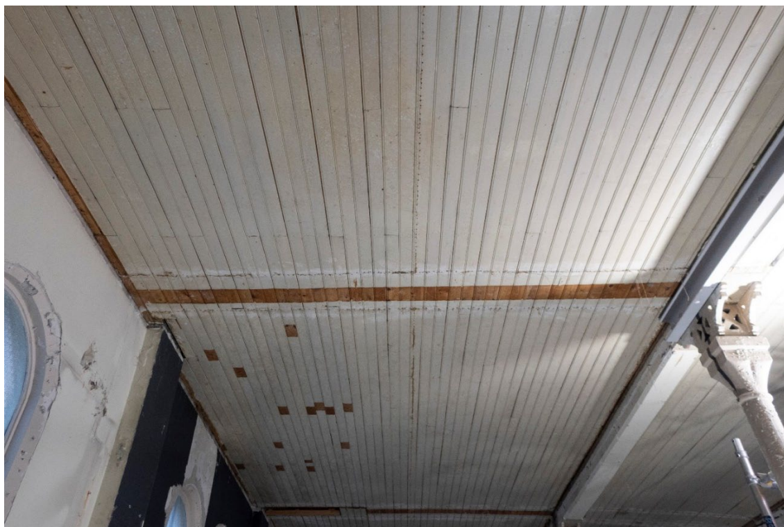
Figur 20 Negative fargespor i den malte himlingen mellom søylene og ut på langveggene. Foto: NIKU, 2023.
