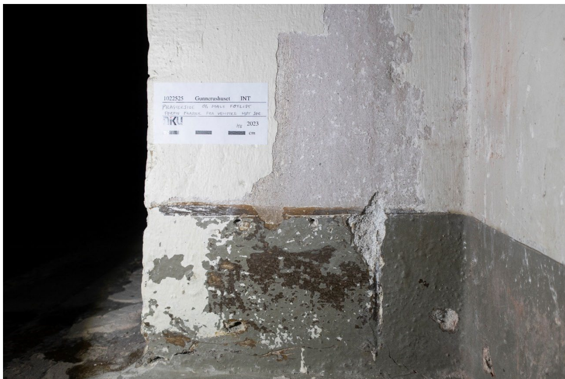
Figur 33 Malt fotlist på vegg og pilaster. Foto: NIKU, 2023.
