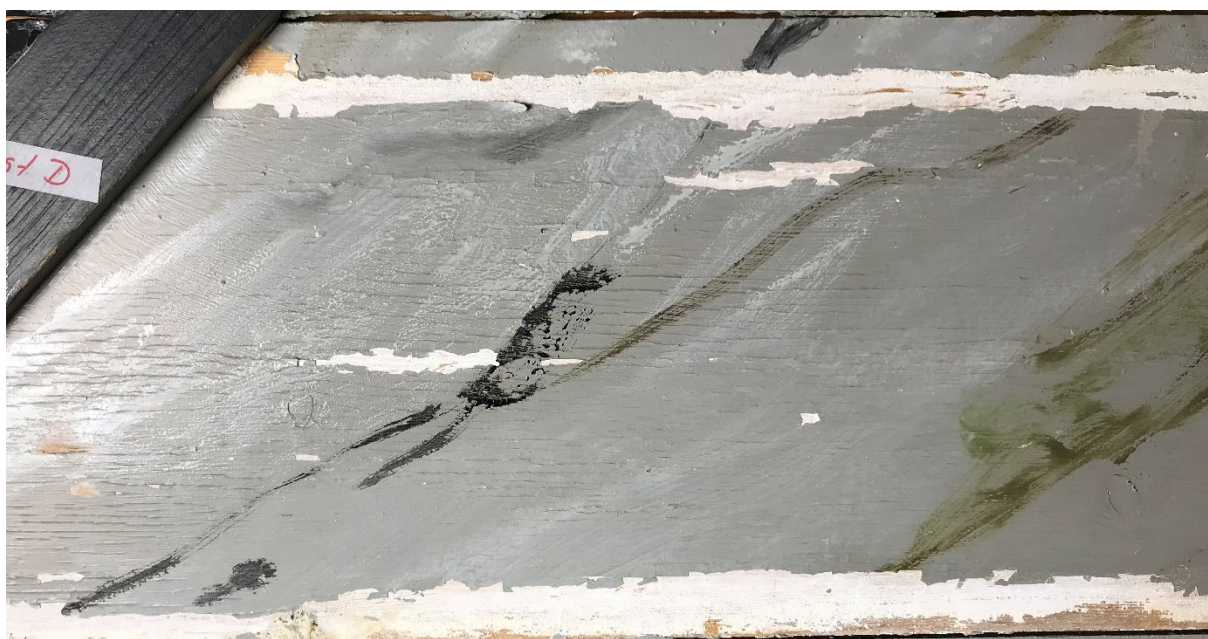
Fig. 4 Testfelt D i område med ådring, konsolidert i juni 2021 med LMK : vann (1:1). Bildet viser tilstanden i oktober 2022. Det er ny løs maling flere mindre steder. Små flak har løsnet fra underlaget, både langs sårkantene og i lukkede tak.
