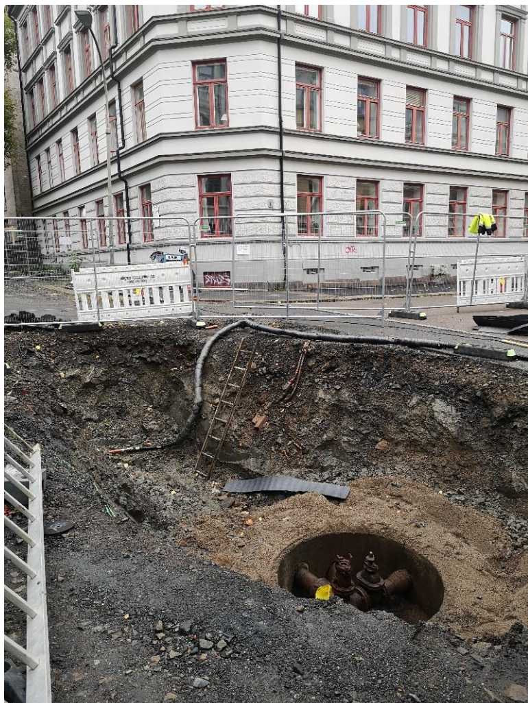
Figur 7: Grøft med eldre vannrør i bunnen midt i krysset mellom Nonnegata og Myklegardgata, sett mot SØ. Foto-nr: Cf54080_NIKU_0004.
