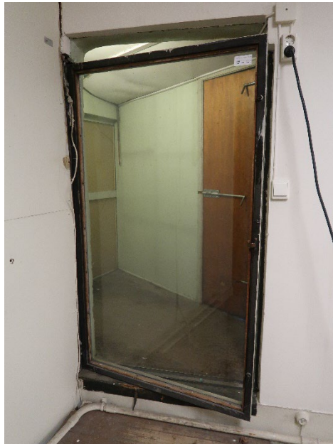
Foto 2: Stålvindu fra siden som ikke er malt inne i lagerrommet
