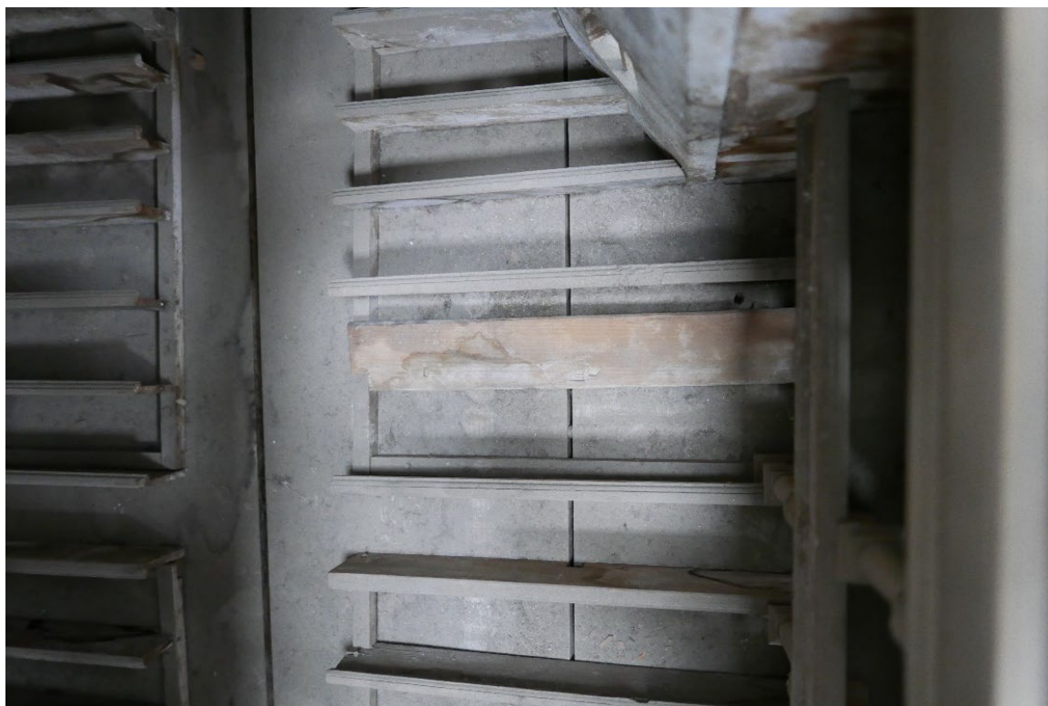
Figur 27 En kirkebenk har løsnet. Det lå et tykt lag med støv og rusk på gulvet. Foto: NIKU 2021
