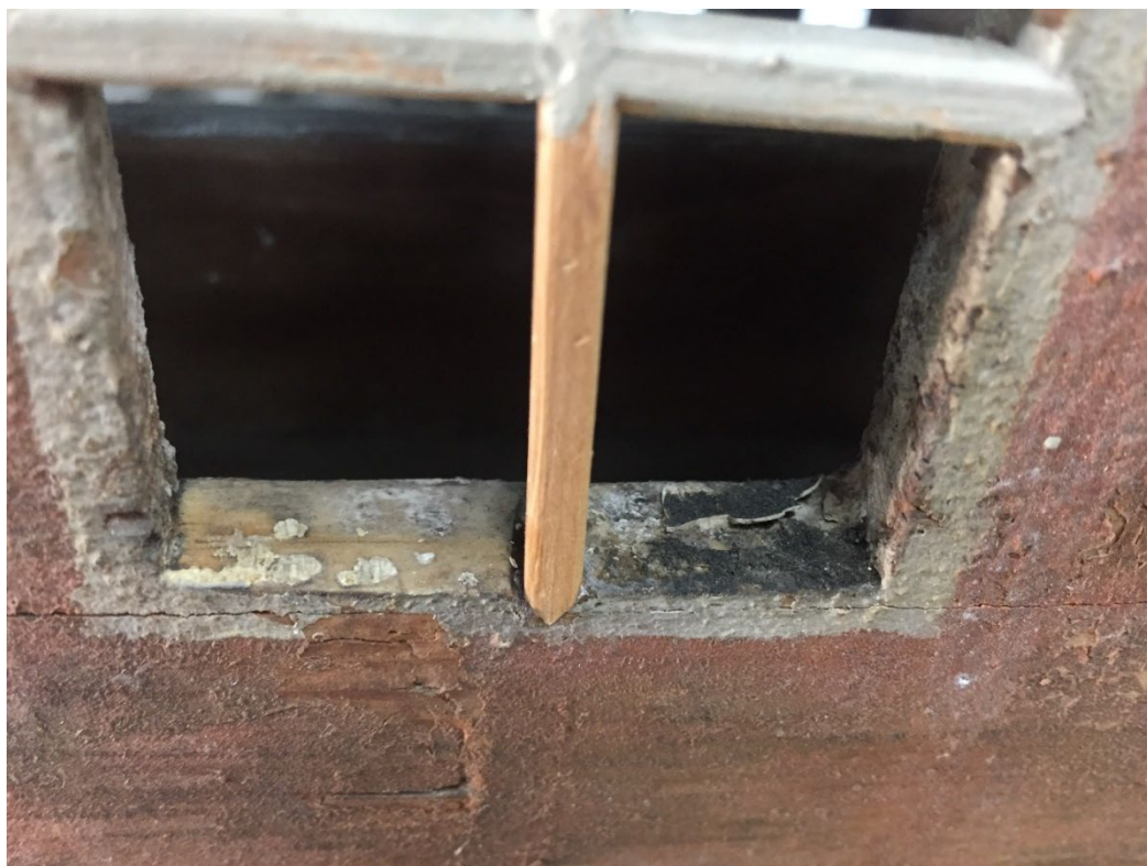
Figur 34 Bunnkarmen i de fleste vinduene hadde løs maling og et tykt mørkt lag med skitt. Foto: NIKU 2021
