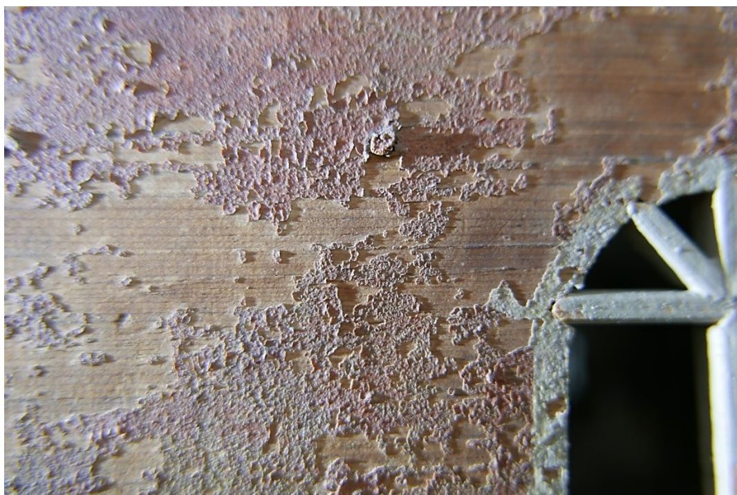
Figur 31 Detalj i sidelys fra område med mye løs maling. Foto: NIKU 2021
