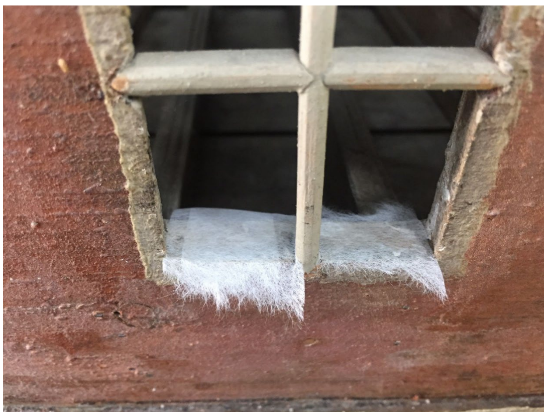
Figur 35 Løs maling ble festet og skitt fjernet på samtlige av vinduenes bunnkarmer og kryssposter samt døråpningene. Foto: NIKU 2021
