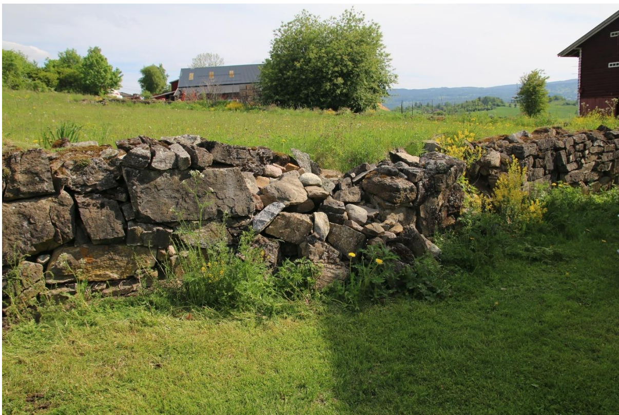
Figur 9: Søndre del av kirkegårdsmuren, hvor et parti hadde rast ut. Sett mot nordøst. Foto: Cf54079_NIKU_01.
