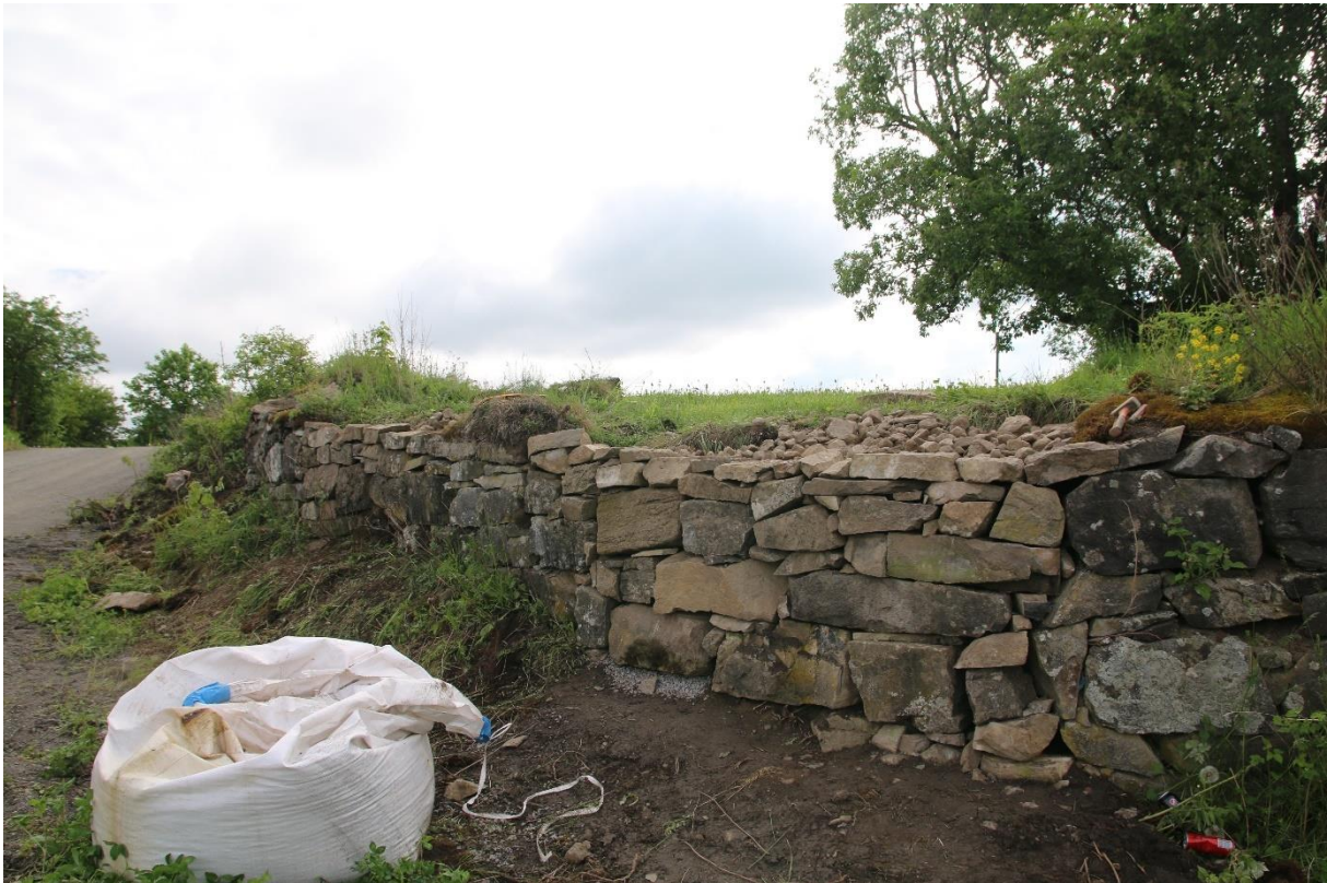
Figur 7: Den nordvestre delen av kirkegårdsmuren etter gjenoppmuring. Sett mot øst. Foto: Cf54079_NIKU_68.
