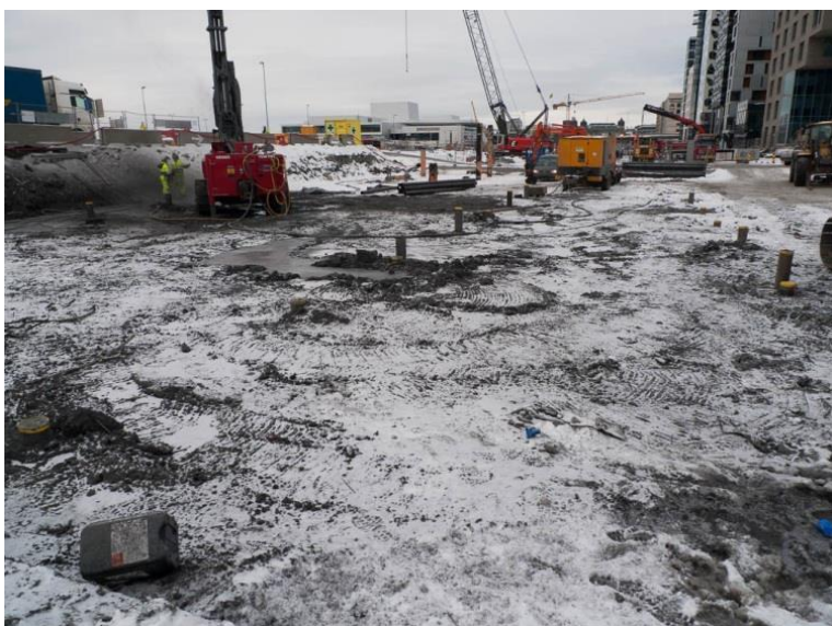
Området hvor brønn MB3 var tidligere, ny byggeplass med pæler er i ferd med å etableres. Foto: NIBIO.
