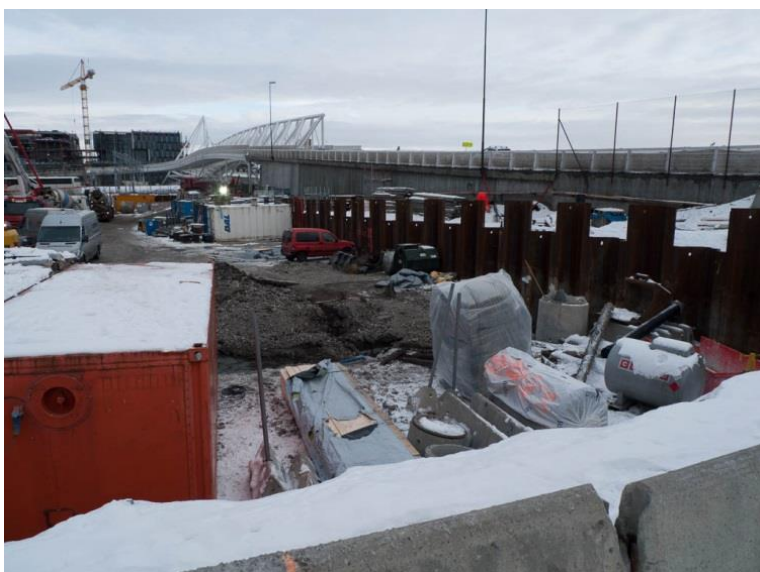
Området ved miljøbrønn MB4. Brønnen har ikke vært lett tilgjengelig pga. bygging av ny spunt og anleggsarbeider. Foto: NIBIO.
