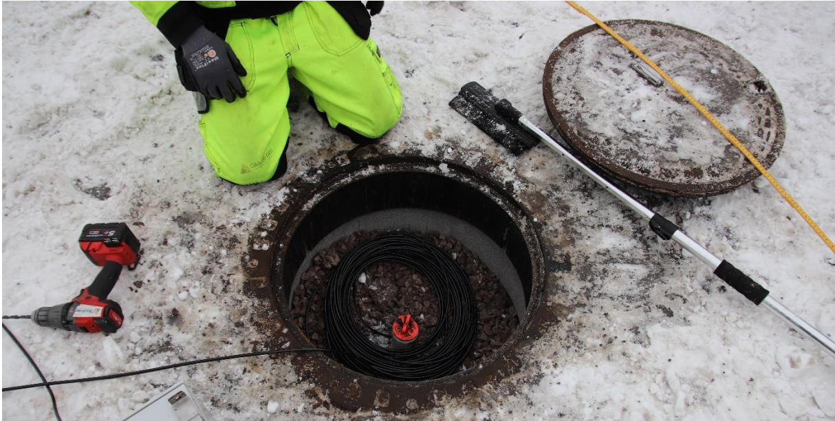
Figur 24 50 m kabel ligger i hver kum Cf53518_NIKU_0086.jpg
