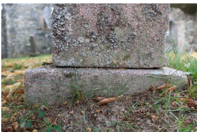
Gravstøtter heller mot vest. Fundamentet dekkes til dels med jord. Fugen mellom fundament og gravstein mangler.
