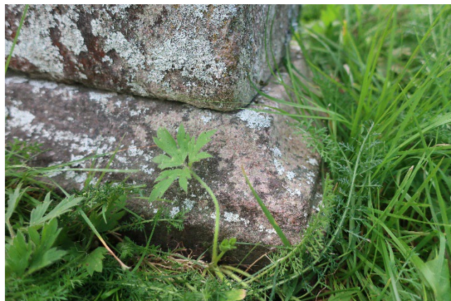
Vegetasjonen tar over og skaper et fuktig mikroklima.
