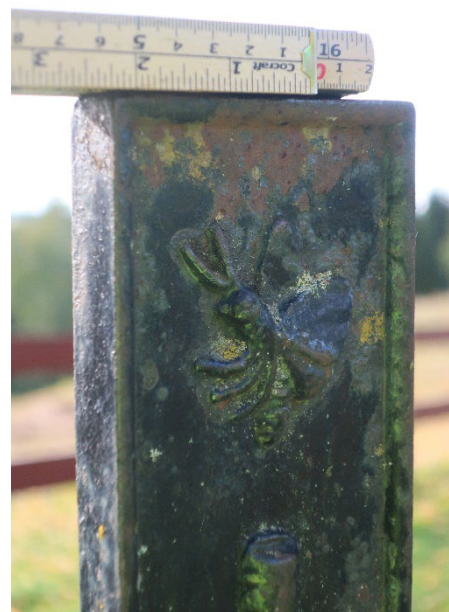
Nedbrutt maling og korrosjon
