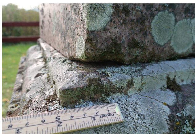
Utfall og manglende fuge.
