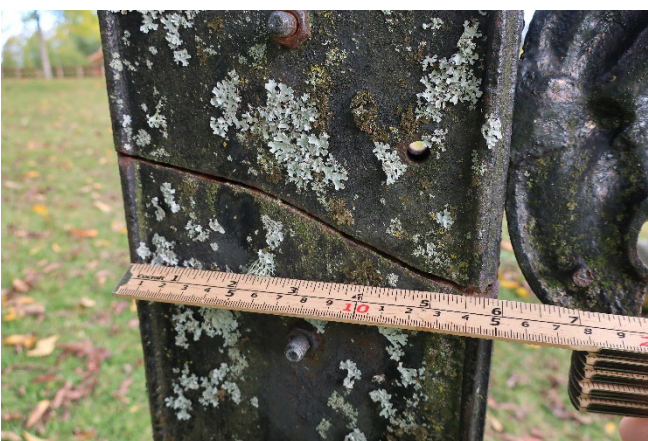
Tverrgående sprekker/ brudd
