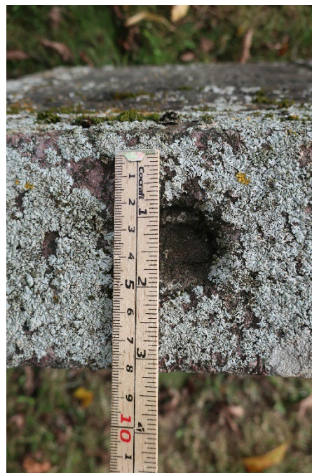
Utdypingen indikerer at et støpejernkors trolig opprinnelig var festet her. Nå samler det seg vann her og det er fare for blant annet frostsprengning.
