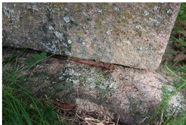
En av flere sprekk som vil lede til utfall.
