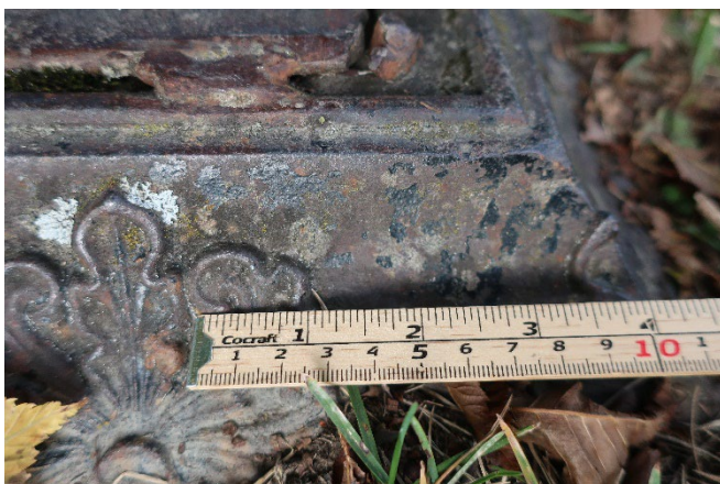
Nedbrutt maling og korrosjon.
