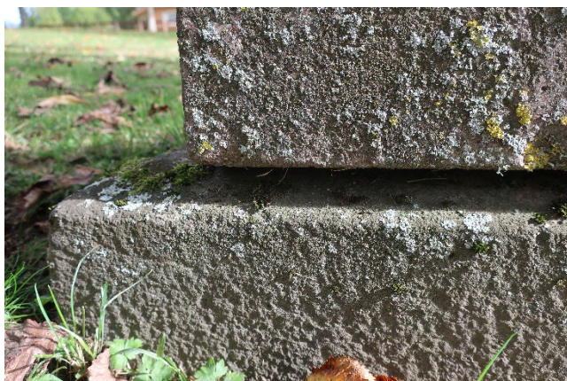
Gravsteinen er større enn fundamentplate og mangler fuge. Bildet viser også relieffforvitring i sidelys.
