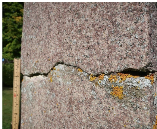
Tverrgående sprekk med utfall langs bruddkanten.
