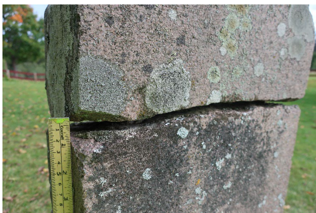
Gravstøtten er brukket i toppen og det forekommer utfall ved bruddkanten.
