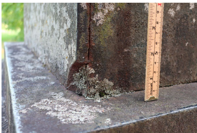
Utfall ved et hjørne
