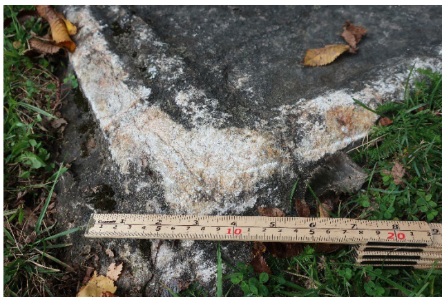
Materialbortfall ved platens kanter og hjørner avhenger av en kombinasjon av forvitring og mekaniske faktorer.
