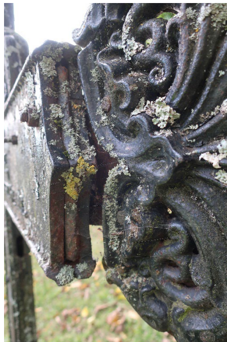
Deformasjon. Konstruksjon blir synlig
