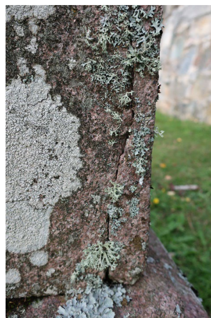
En sprekke som helt sikkert vil føre til avskalling og dermed tap av materiale hvis den ikke blir reparert.
