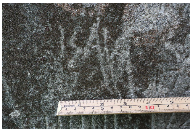
Innrissinger i framsidens overflate. Uklart hvor dypt den går.
