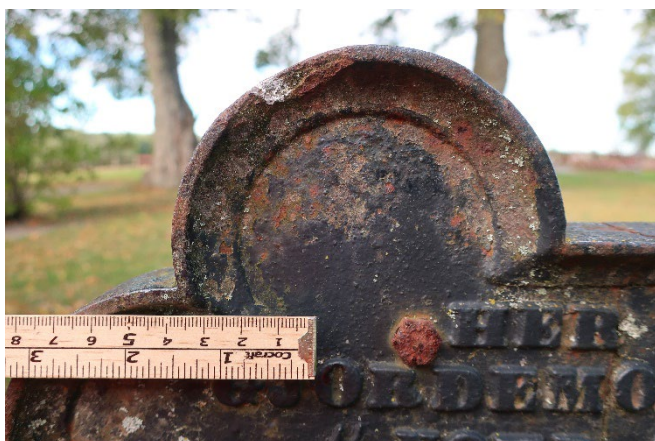
Korrosjon og utfall
