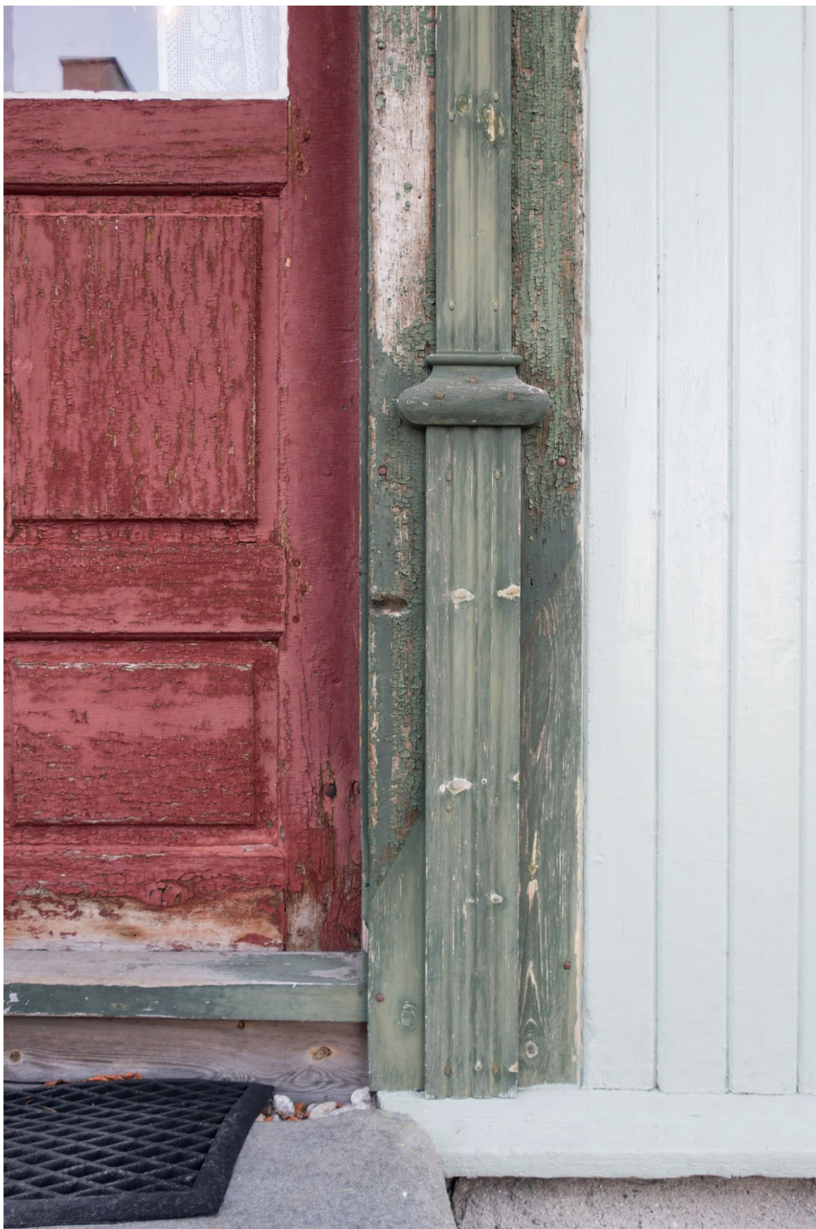
Figur 6 Nedre del av dør og portal. Innbøtninger og sekundære utskiftninger. Foto: NIKU, 16.11.2022.
