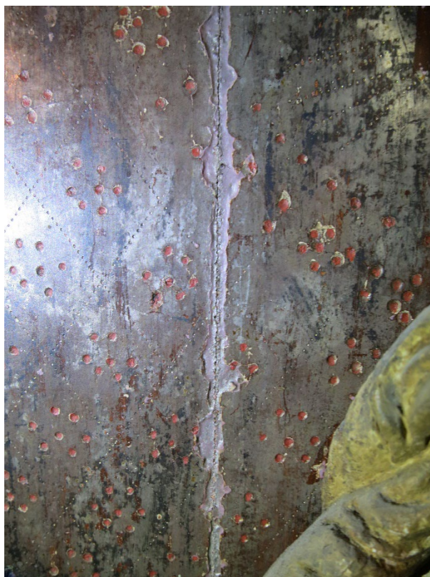
Bildet viser avskalling av malingslag og forsølving på bakveggen i korpus.
