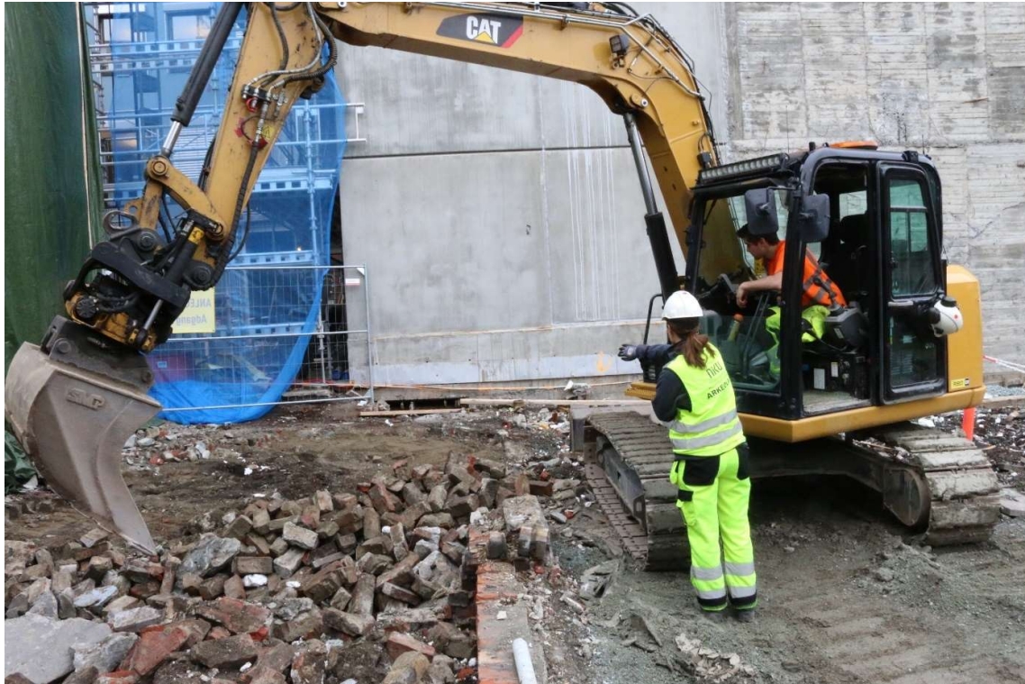
Figur 8: Utgravningsleder Ingeborg Sæhle samarbeider med maskinfører Göran Børseth fra Tverås AS for å få fjernet de moderne massene i tiltaksområdet. Foto: Da62865_3191.
