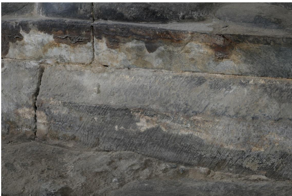
Figur 109. Under restaureringen på 1860-tallet ble alle synlige overflater i skipet overhugget eller pusset med sandpapir. Samtidig gikk alle innskrifter og verktøyspor og eventuelle steinhuggermerker tapt. Under tregulvet er steinenes opprinnelige overflater fra middelalderen bevart. I bildet sees basen til halvsøylen i søndre sideskip, mellom felt D5 og D6. Felles for alle de tidligromanske steinene i krypkjelleren under skipet var at de var skråhugget med et redskap som ga fine, tynne og skrå linjer i steinoverflaten. Foto Sf216623.
