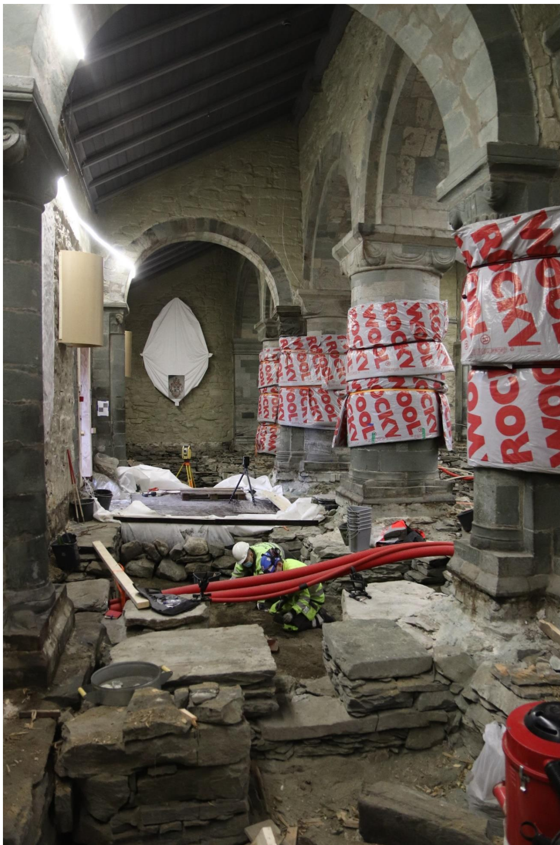
Figur 3. Undersøkelsene måtte utføres kammer for kammer. Hvit duk viser gjenfylte masser i kammer D4, som er ferdig dokumentert og fylt igjen. Sikker tilkomst videre inn i krypkjelleren er etablert oppå de gjenfylte massene. I kammer A5 er Jani Causevic, NIKU, og Sean D. Denham, AM UiS, i ferd med å rense frem jordgulv med eksponerte graver. Foto er tatt fra kammer D6, som er sikret for bygningsarkeologisk dokumentasjon. Foto Sf209229.
