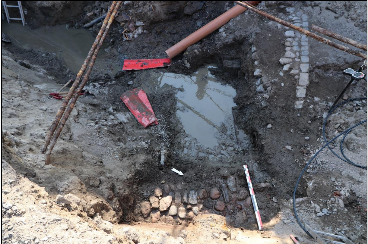
Figur 4. Bilde CF53873_NIKU 0011 som viser brosteinslagene som fortsetter under Prinsessegata (nederst i bildet) Øverst og til høyre i bildet ses kantsteinene tilhørende broleggingen i Telemarksgata. På høyre siden av det våte området i midten kan kanten av den kvadratiske trekummen S9084 ses.
