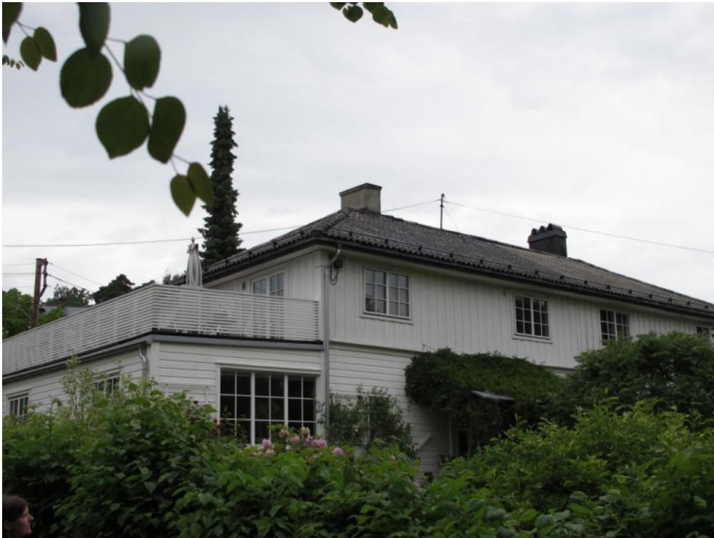
Figur 54 Abbediengveien 11 og 12 - fasade mot hage. Foto viser tilbygg stueareal 1.etasje. Hjørnevinduer fjernet i forbindelse med tilbygg. Ny verandadør ut mot terrasse over tilbygg.
