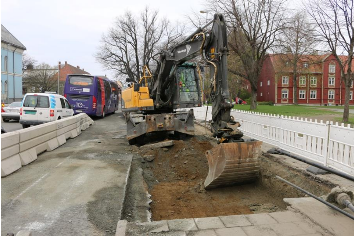
Figur 6. Graving av østlig fundamentsjakt. Stripe med rasleire dukket opp i kanten av sjakten mot øst. Bildet er tatt mot nord. Da62828_NIKU_06.
