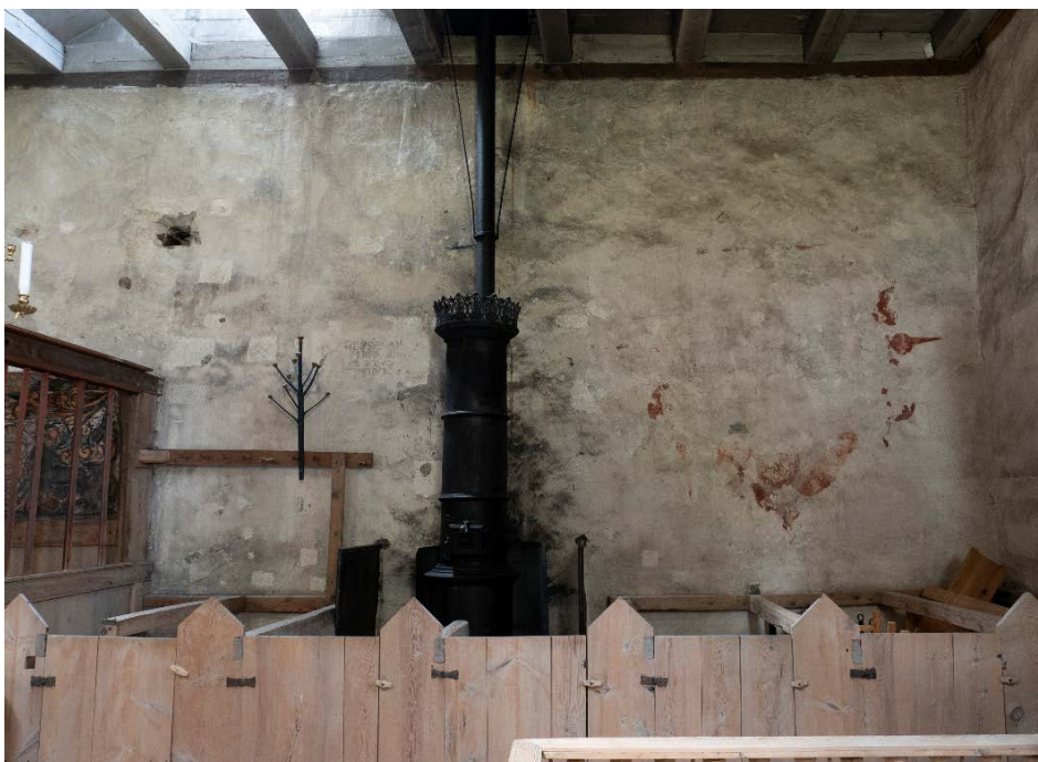
Figur 13: Veggoverflatene og kalkmalerifragmenter i Eidfjord gamle kirke er svært tilstøvet og skitten. Foto: Susanne Kaun
