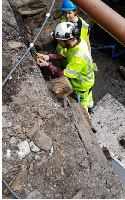
c) Sensor installasjon
