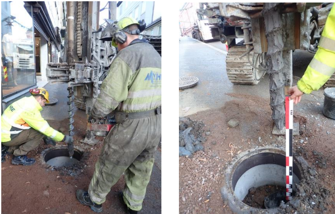
Figur 16: Bilder fra felt ved boring av miljøbrønn TO1. Tv.: Rensing av bor. Th.: Siste borelengde ved påtruffet grunnfjell.
