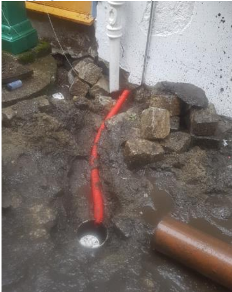
c) Trekkør for sensorkabler
