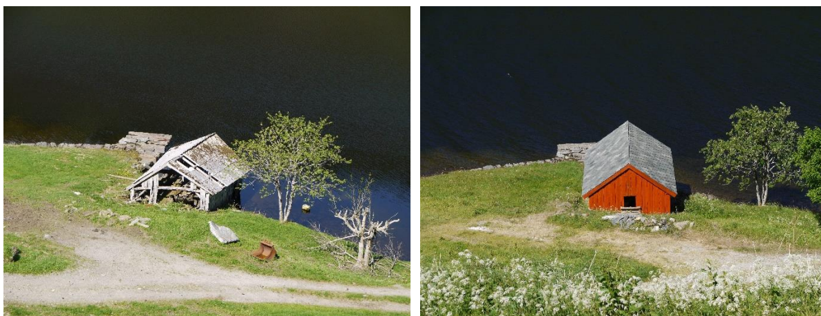
Naust i Flora kommune før og etter istandsetting. I 2013 ble naustet registrert som sterkt truet av forfall, men i 2018 var bygningen istandsatt og ble registrert som intakt. Foto: EA/NIKU 2013, ÅD/NIKU 2018
