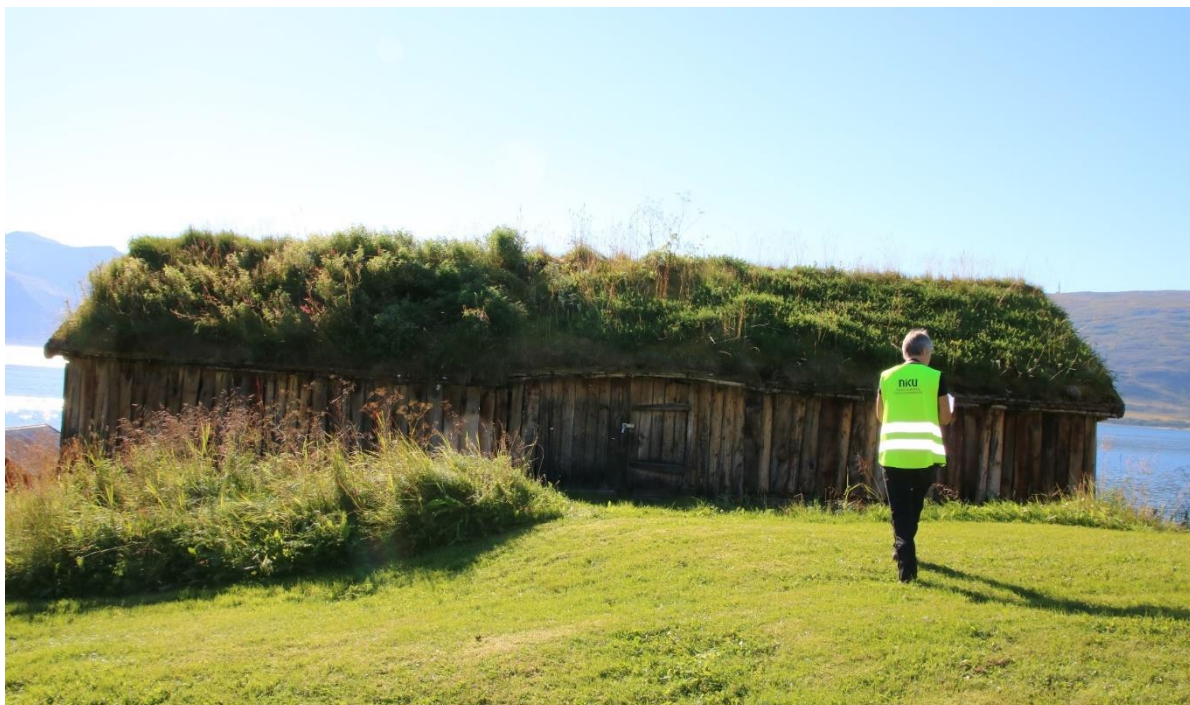
Kontrollregistrering av SEFRAK-bygninger på Kvaløya i Tromsø, på museumsområdet Gammalgård i Straumbukta. Ifølge foto og tekst på SEFRAK-skjemaet ( neste side) hadde bygningen takpapp da den ble SEFRAK-registrert i 1992. Ved kontrollregistreringen var taktekingen endret til torv, og huset ble registrert med overflateendring. Foto: TW/NIKU 2016
