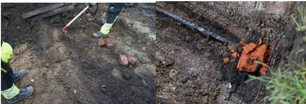
Fig 5. «Oljekabel» med rød teglstein som beskyttelse og markør. Plankene lå i matjordlaget over kabelen.
