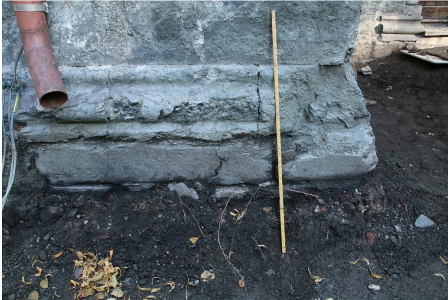
Figur 15: Sokkel/øvre del av fundament ved sørveggen til mellomalderdelen av skipet. Foto: Da62838_045.
