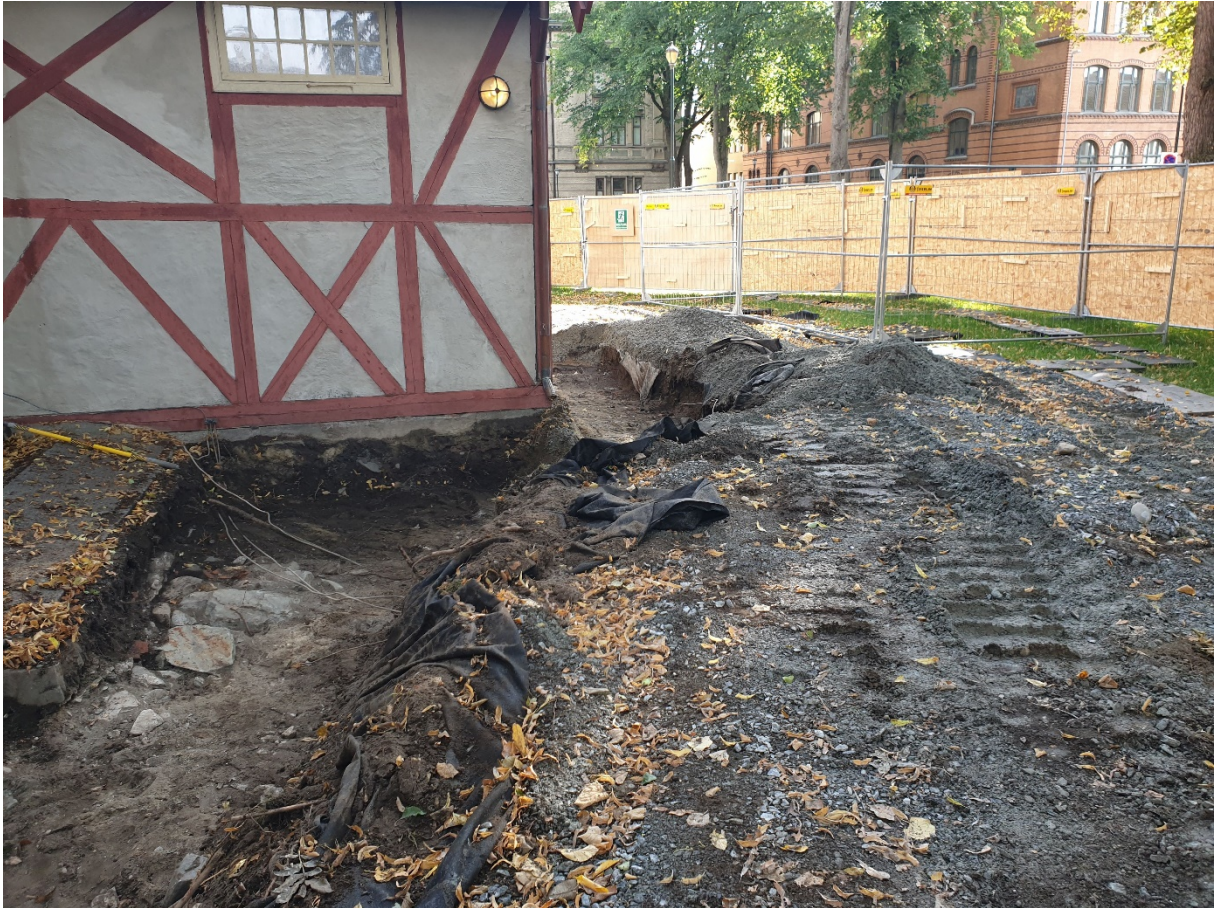
Figur 24: Dreneringsgrøfta ved betongdekket og Sunnivakapellet sett mot aust. Ein ser ei steinlegging ved muren under betongdekket. Kablar kryssar grøfta. Foto: Da62838_078.
