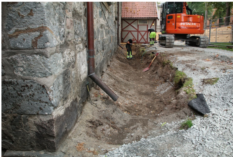
Figur 11: Grøftekanten inntil veggmurane var skrånande for å beskytte nedre del av veggmur og øvre del av fundament. Fotoet viser grøfta langs skipet vest for Sunnivakapellet. Foto: Da62838_018.
