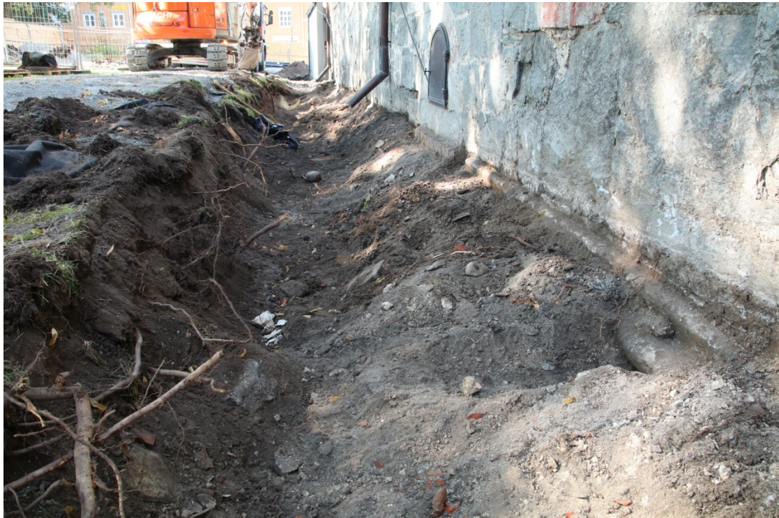
Figur 23: Grøfta ved sørveggen til skipet, sett frå mellomalderdelen av skipet og vestover. Ein del av sokkelen til mellomalderskipet er grave fram. Foto: Da62838_010.
