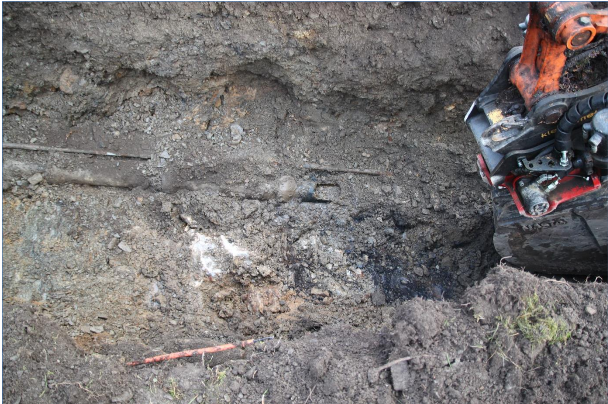
Figur 21. Grøft VA-anlegg, betongrør med rektangulær åpning med kobling til andre rør samt en galvanisert vannledning. Mot Ø. Foto Hilde R. Amundsen 2020 (Cf53906_NIKU_0020).
