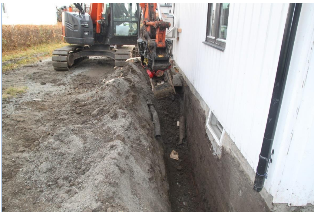
Figur 7. Dreneringsgrøft Ø, søndre del med eldre VA-rør i omrotete masser. Mot S. Foto Hilde R. Amundsen 2020 (Cf53906_NIKU_0011).
