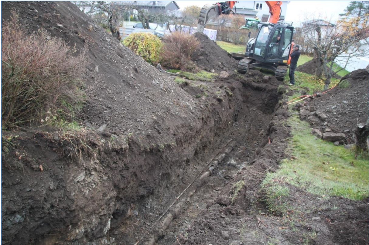
Figur 5. Grøft VA-anlegg, graving sørover i hagen. Mot Ø-SØ. Foto Hilde R. Amundsen 2020 (Cf53906_NIKU_0022).
