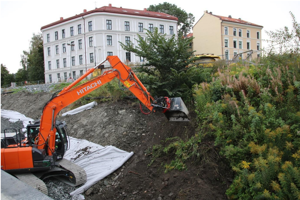
Figur 8: Gravemaskin anvender tilkomstvei mot sør i tiltaksområdet. Sett mot nordøst. Foto: Cf53684_NIKU_025.
