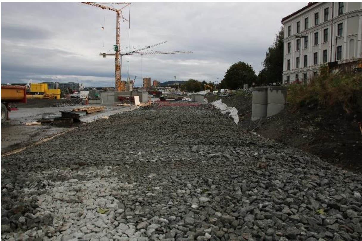
Figur 10: Tiltaksområdet er fylt opp til samme nivå som taket til kulvert K135. Sett mot nord. Foto: Cf53684_NIKU_041.
