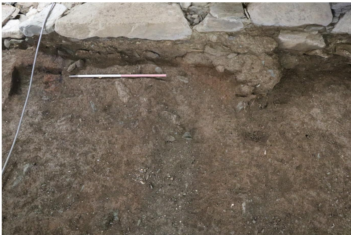
Figur 20. Under den store hella innerst i døråpningen i vestmuren – øverst i bildet, over målestokken – var det mørtel nedover sokkelen. Omtrent 50 cm nord for hella var det store klumper mørtel et stykke ut fra sokkelen. Det rødbrune laget er SL1293. Til venstre, under ledningen, ligger SK1242 (se 3.5.1). Målestokken er 1 m. Sett mot nord. Foto Sf202320.
