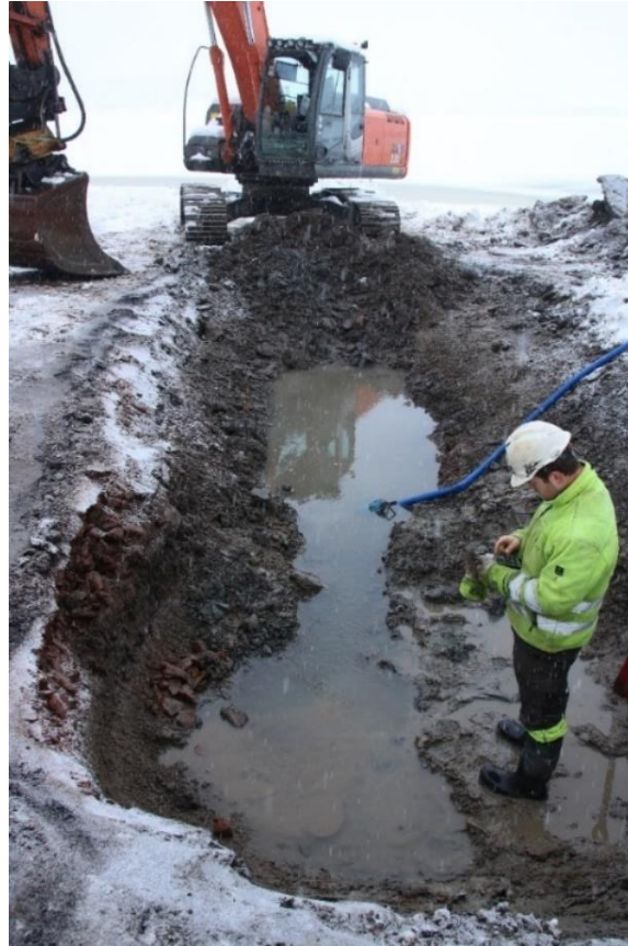
Figur 2 Cf53898_NIKU_0024.jpg Vanninntrenging i grøft hindret gravearbeider 20. januar
