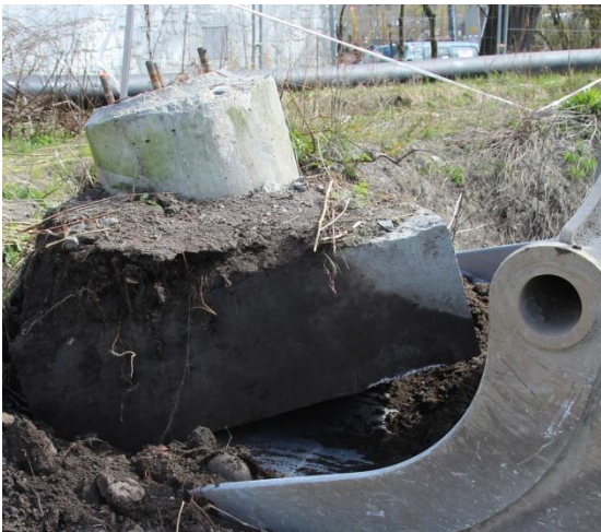
Figur 28 Fjerning av betongføtter til gangbro. Merk kuppelsteiner - sannsynligvis fra 1700-tall - i massene direkte under sokkelen (se 6.6.2).
