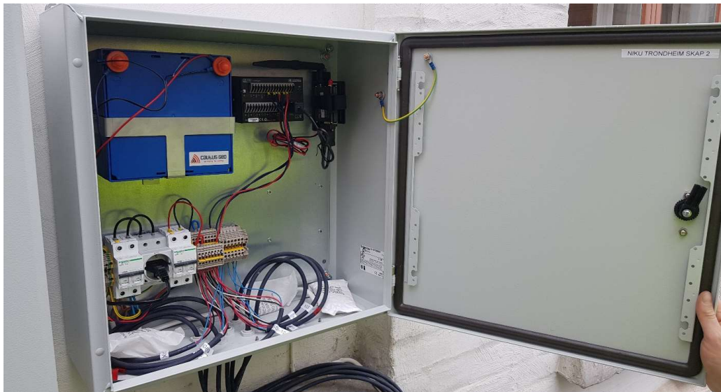
Figur 11. Ferdig montert skap, sett fra innsiden.
