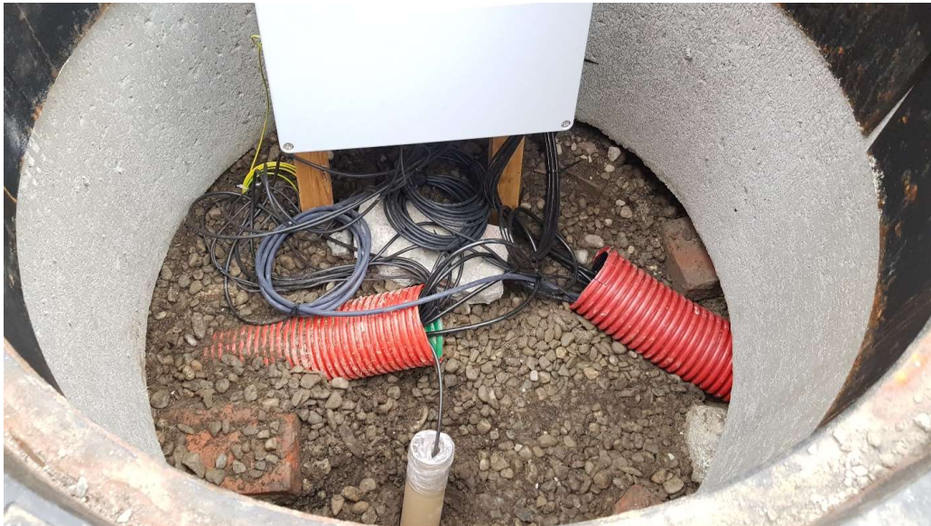
Figur 10. Ferdig montert kum. Øverst i bildet: Koblingsboks plassert i kum. Midten: trekkerør for sensorer. Under: Referansesonde for pH- og redokksensorer.
