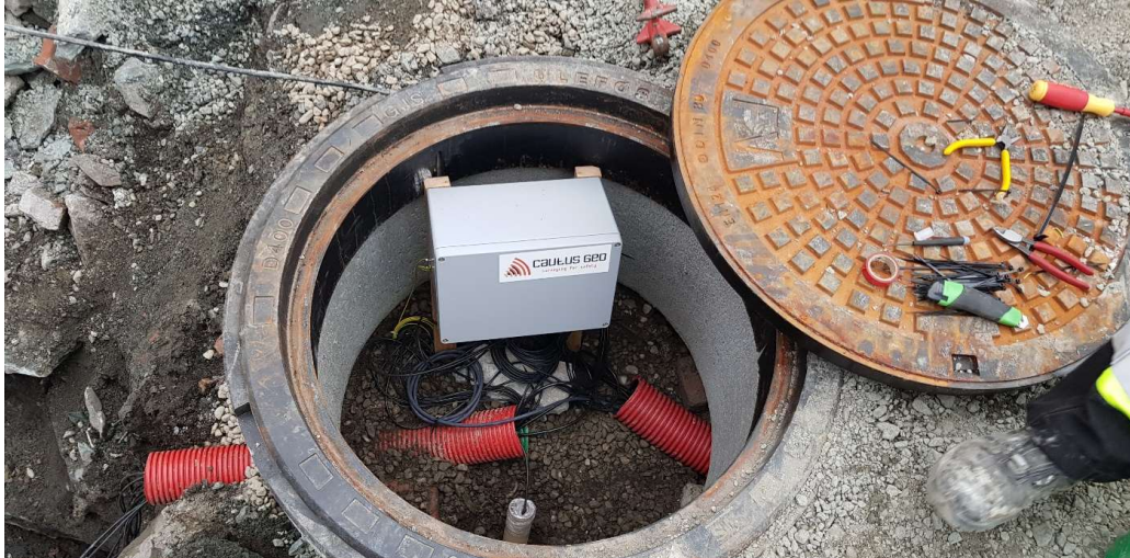
Figur 9. Koblingsboks i kum ved miljøprofil 3.
