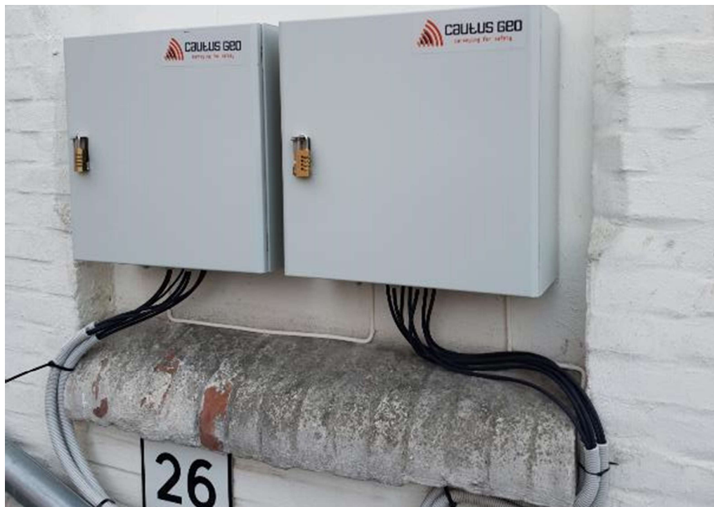
Figur 12. Ferdig monterte skap
