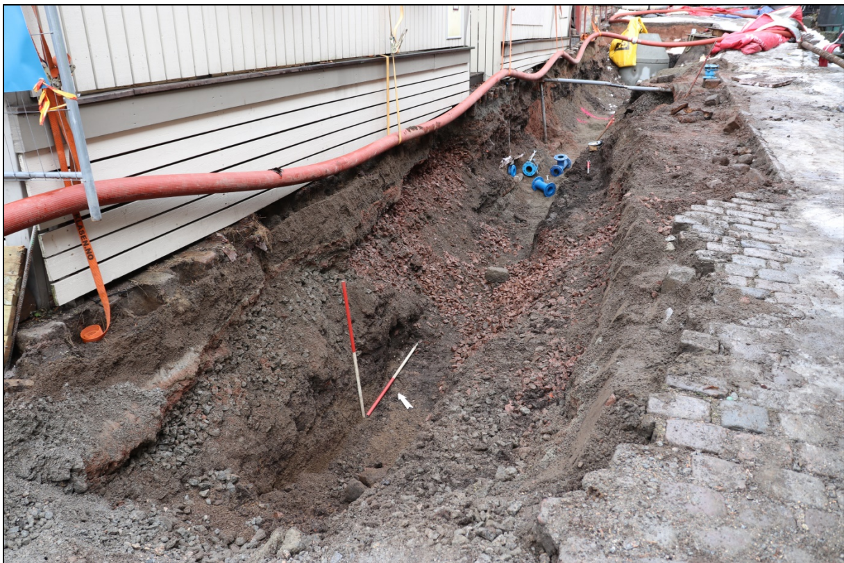
Figur 6. Vannledningsgrøft M20709 ved sydsiden av Nedre Langgate 28B. Sett mot NØ. Cf53900_NIKU_884241.
