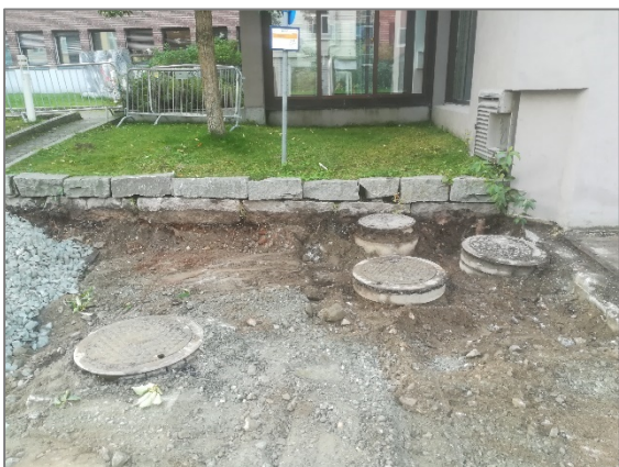
Figur 3: Fortau og masse fjernet omkring kummer 27.09.2019 midt i tiltaksområdet. Foto: NIKU.
