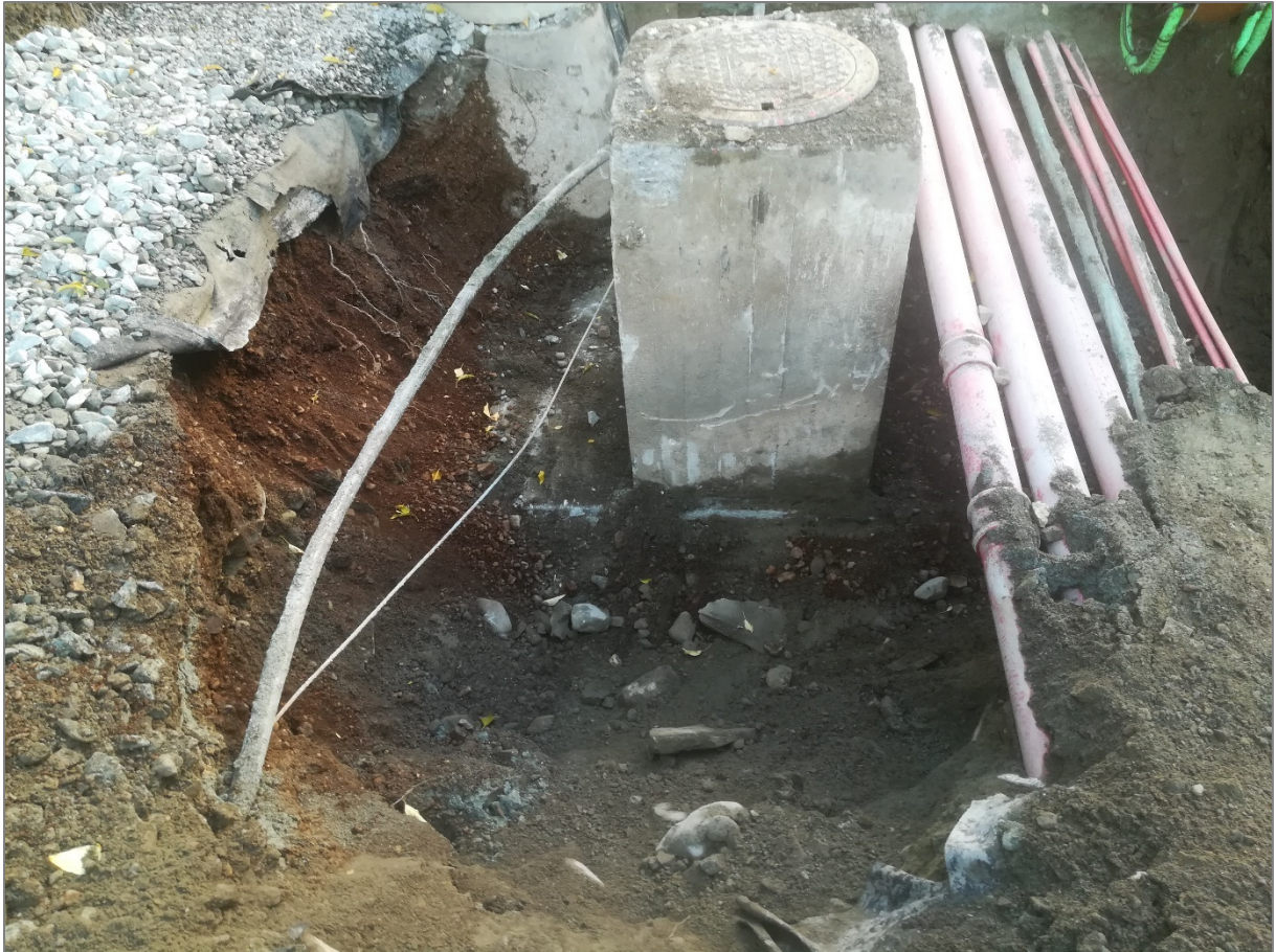
Figur 12: Eldre kum av plasstøpt betong. Det ble ikke gravd lenger ned enn til bunnen av denne i forbindelse med anleggelse av ny VA kum. Foto: NIKU 2019.
