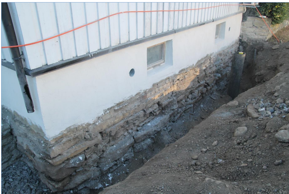
Figur 12. Detalj av grøft vestsiden av Korsgata 31, VA-rør fra 1990 mot husvegg. Mot S-SØ. Foto Hilde R. Amundsen 2020 (Cf53897_NIKU_04).
