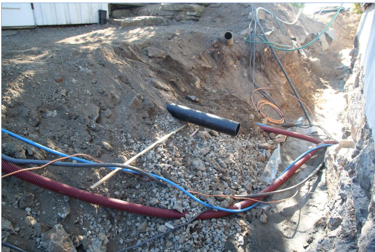
Figur 5. Nordre del av østre profil i østre grøft med rør, ledninger. Mot S-SØ. Foto Hilde R. Amundsen 2020 (Cf53897_NIKU_13).
