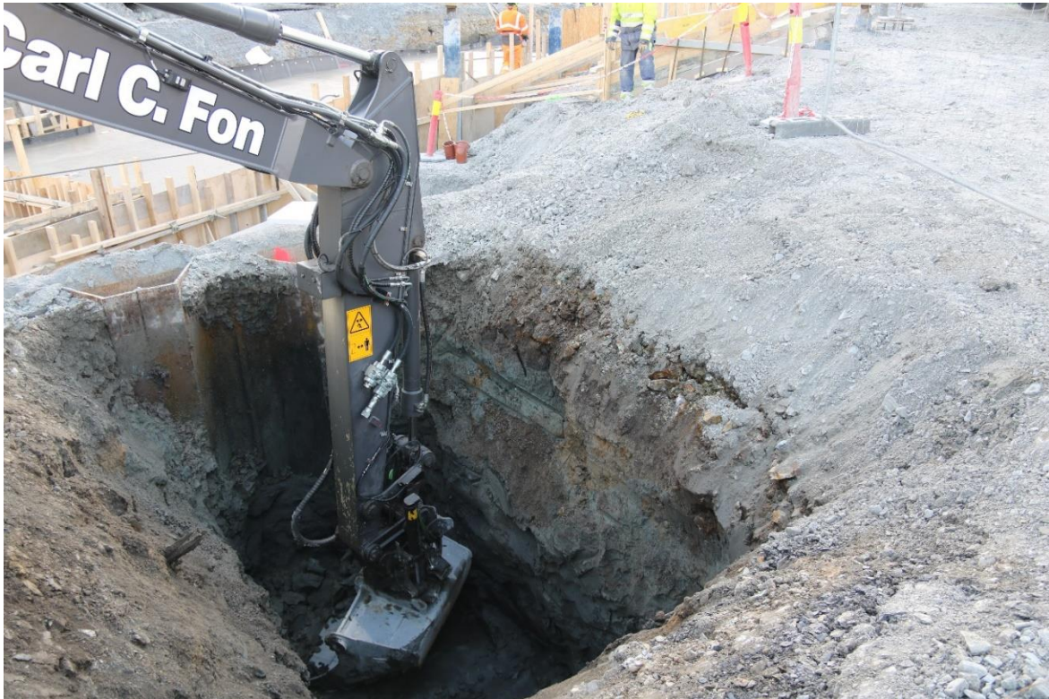
Figur 10: Grop gravd på «Militærrampa» inn mot ny trafobygning. Sett mot sør. Foto: Cf53705_NIKU_120.
