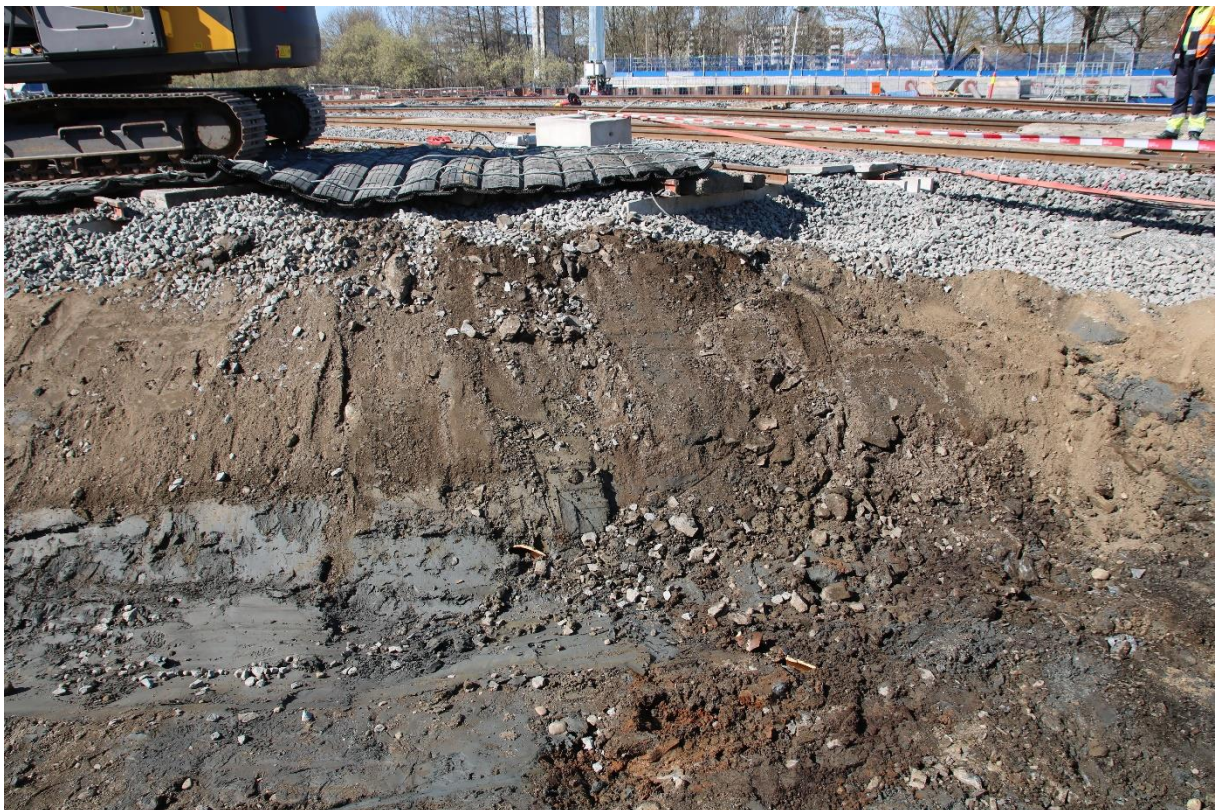
Figur 8: Profilet i grøften med tydelig lagskilte mellom påført alunskifer og sand på blåleire. Restene av et moderne rør er synlig i bunnen av grøften. Sett mot vsts. Foto: Cf53705_NIKU_042.
