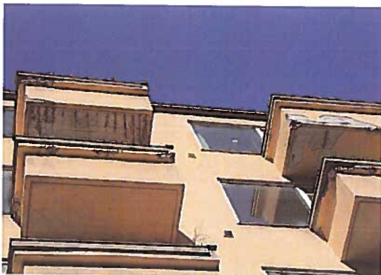
FIGUR 5. Armeringsskader på balkonger på en funksjonsblokk (Mariesgate/Kirkeveien, Oslo). Karbonatisering er en naturlig kjemisk prosess som oppstår når en betongoverflate er i kontakt med luft. Når karbonatiseringen når inn til armeringsjernet som ligger inne i betongen kommer luft og fuktighet i berøring med jernet. På denne måten korroderer jernet og danner det vi i dagligtale kaller for rust. Rusten har et vesentlig større volum enn jernet, og dette fører til sprengvirkning inne i betongen. Etter hvert vil betongen sprekke opp, og jernet blottlegges. På sikt vil bæreevnen i den armerte betongen svekkes. Jo lavere overdekning over armeringsjernet, jo mer utsatt er konstruksjonen for slik rustsprengning. Under funksis-perioden ble det eksperimentert med liten overdekning for å skape tynne og luftige konstruksjoner. Disse er derfor spesielt utsatt for slike skader. FOTO: NIKU/E. Hole, 2012.
