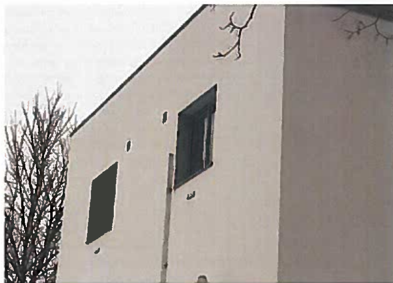
FIGUR 7. Utvendig etterisolering av veggen kan føre til store endringer i fasadeuttrykket. Vinduet blir liggende langt inne i vegglivet dersom man ikke samtidig flytter dem ut. FOTO: NIKU/AC. Flyen, 2017.
