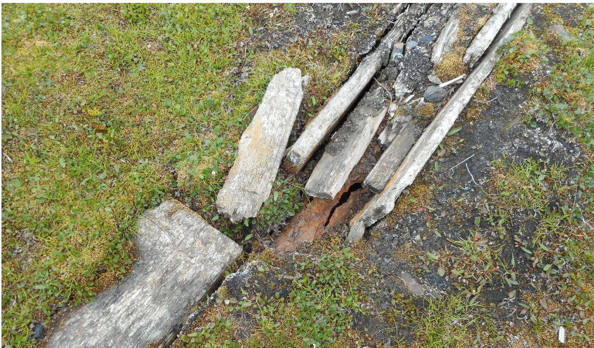
Figur 26: Detalj av rør i rørkasse under veifar i Gamle Longyearbyen. Røret er i jern og rørkassen er i treverk. Rørkassen er presset opp av fryse/tine-prosesser i veimassene. Foto: NIKU/AC Flyen
