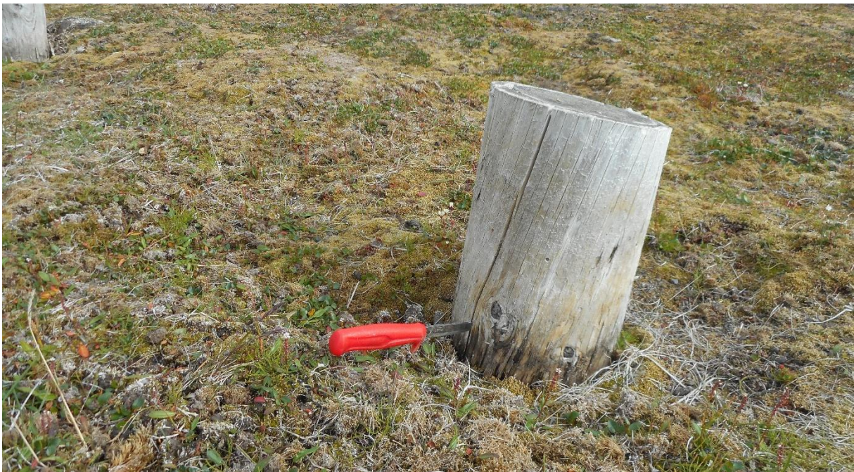
Figur 36: Råteundersøkelse inn via en sprekk i en av pelene i tuft B. Foto: NIKU/AC Flyen
