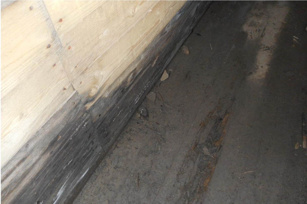
Figur 68: Nedre deler av vegg og gulv i gangen. Treverket er tydelig fuktbelastet. Gulvet er svært vått, og det er enkelte mindre, lokale råteskader. Foto: NIKU/AC Flyen
