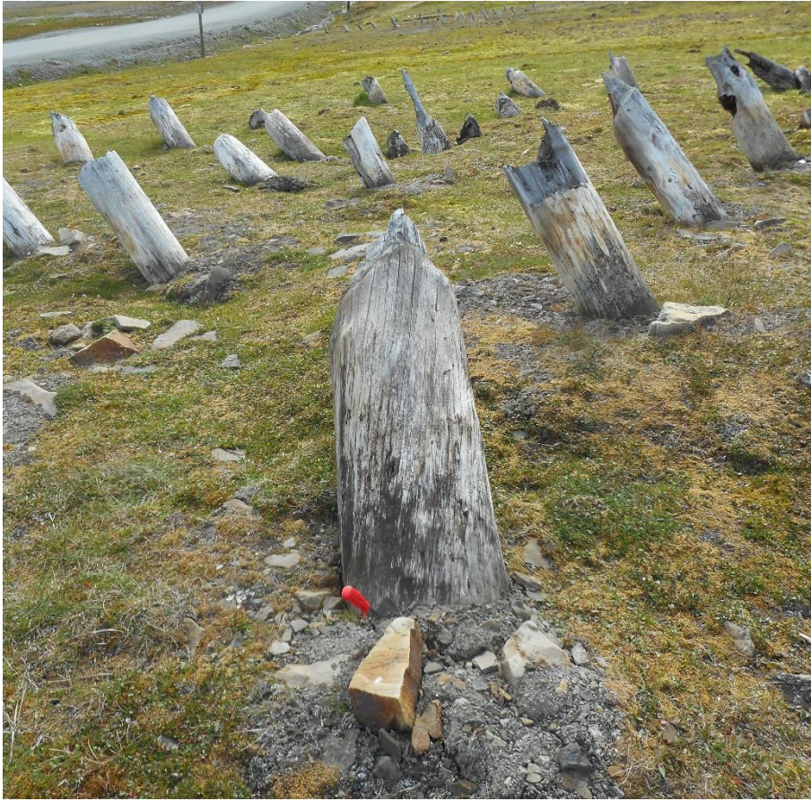
Figur 48: En av de store pelene i tuft C som ble undersøkt. Også i denne pelen er det kraftig råte i nedre del av pelen. Denne som lå helt nede på bakken hadde innvendig råteskade som gikk noe lenger opp enn de to andre som ikke ligger like langt nede. Forskjellen var ca. 5 cm. Se for øvrig tabell 11. Foto: NIKU/AC Flyen.
