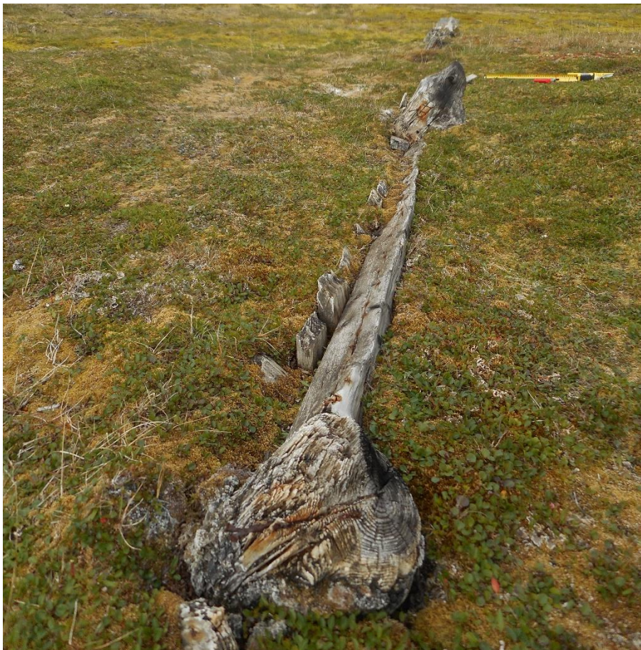
Figur 30: Deler av panelt vegg i tuft A. Treverket er brutt ned av råte, og kan lett ødelegges om det blir tråkket på eller sparket i. Foto: NIKU/AC Flyen
