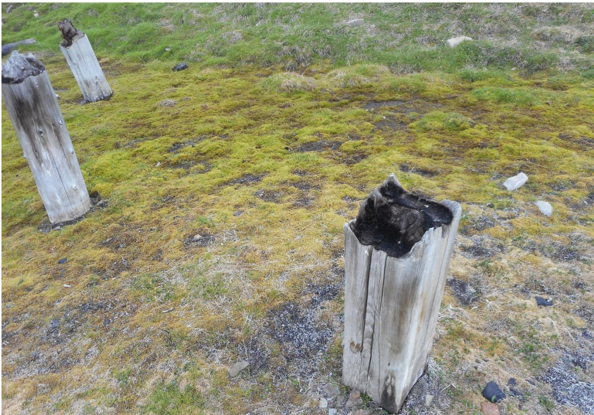
Figur 53: De to pelene i tuft D som ble undersøkt: den fremste til høyre i bildet og den bakerste. Begge pelene var sterkt nedbrutt innvendig, men i den som sto våtest gikk angrepet noe høyere opp fra overflaten av bakkenivå enn i den som sto noe tørrere, forskjellen var ca. 5 cm. Det er et for lite utvalg til å kunne si om forskjellen var tilfeldig. Foto: NIKU/AC Flyen.
