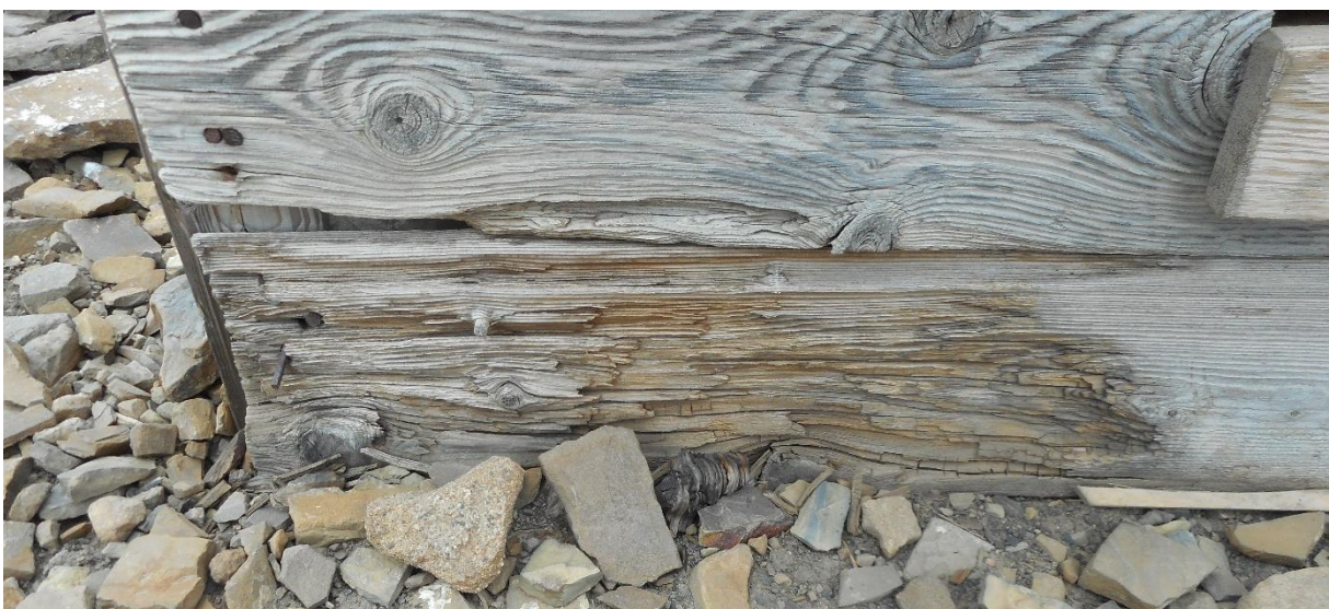
Foto 67: Detalj av gammel råteskade ved nedgangen til kommandoplassen. Foto: NIKU/AC Flyen
