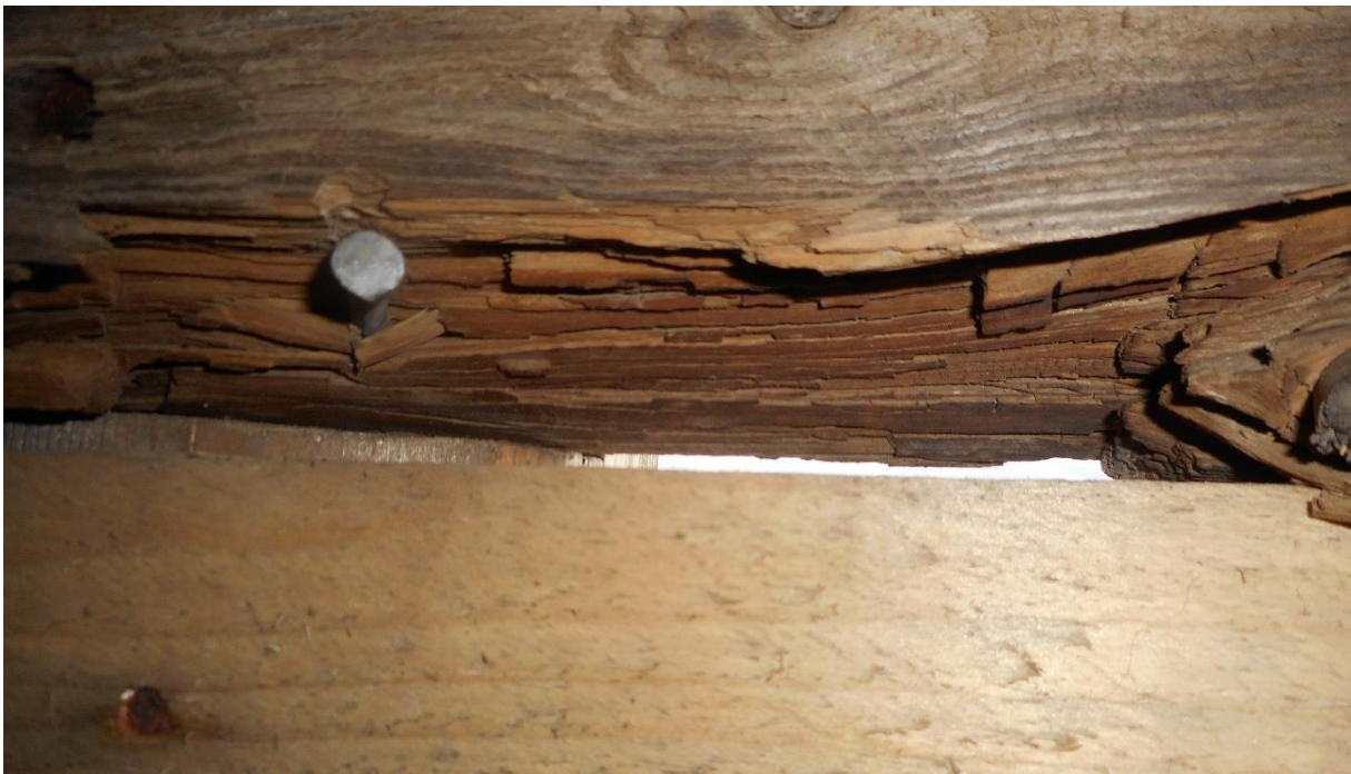
Figur 69: Detalj av gammel råteskade. Foto: NIKU/AC Flyen
