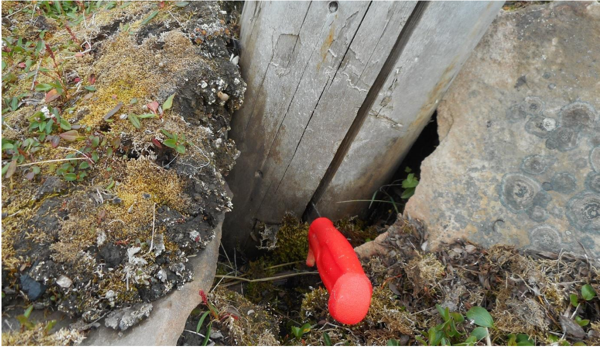
Figur 27: Råte. Undersøkelsene av råte inne i pelene ble gjennomført ved at en knivspiss ble ført forsiktig inn i en eksisterende sprekk i pelen. Foto: NIKU/AC Flyen
