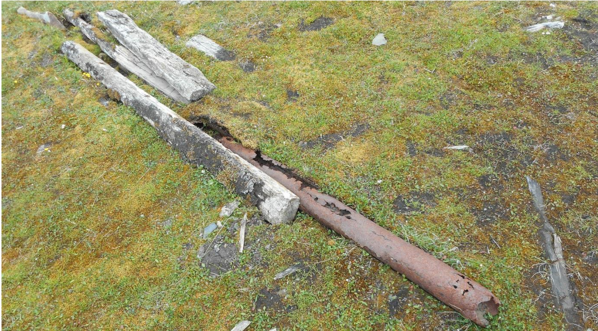
Figur 25: Rør i rørkasse under veifar i Gamle Longyearbyen. Røret er i jern og rørkassen er i treverk. Rørkassen er presset opp av fryse/tine-prosesser i veimassene. Rørkassene/rørene ligger tvers over veien og i Askeladden er disse tolket som drenering. Treverket er nedbrutt av råte og jernrøret er korrodert (rustet) tvers gjennom godset. Foto: NIKU/AC Flyen.
