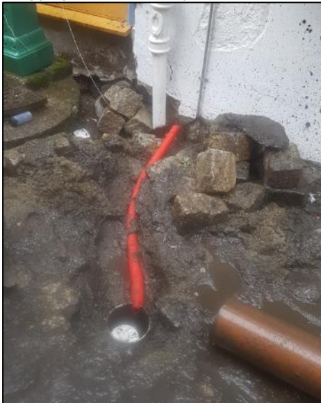
c) Trekkør for sensorkabler
