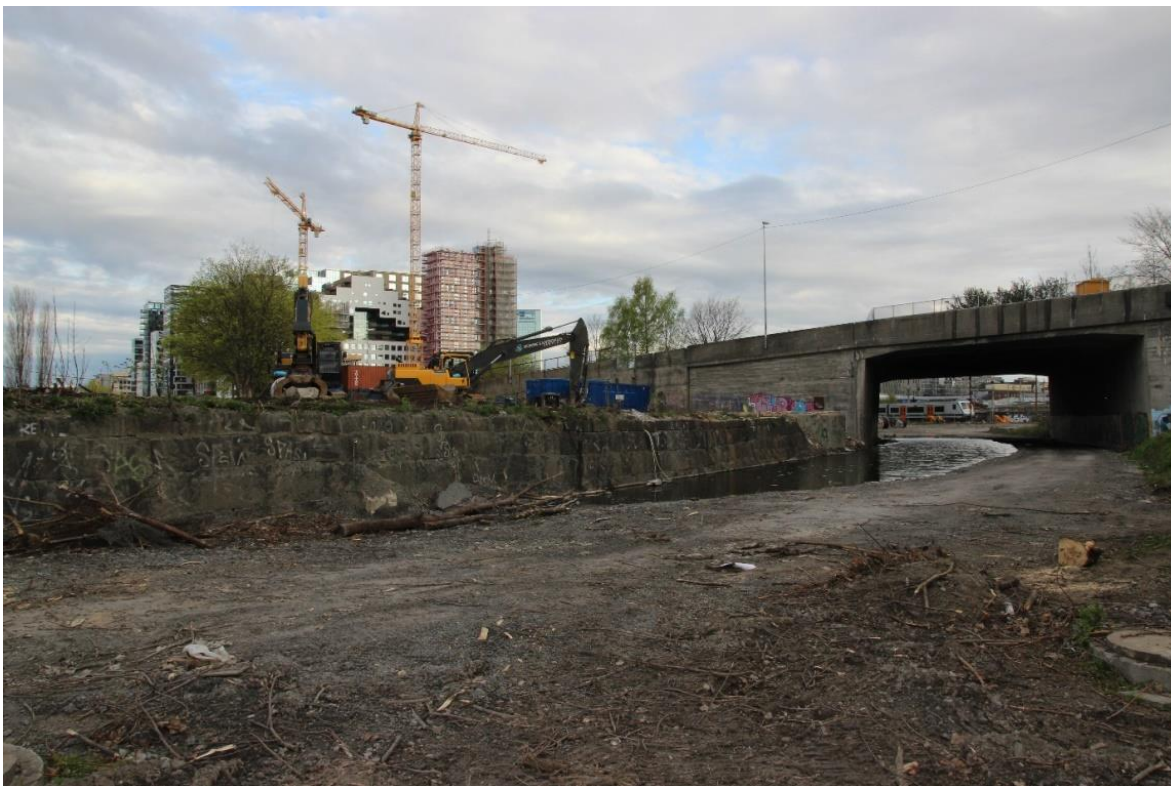
Figur 72. Klypen ved Bispegata Bro, etter at Borgen ble revet. I bakgrunnen ses bygningene i «Barcoderekken». Foto mot nordvest (Cf34987_NIKU_0035).
