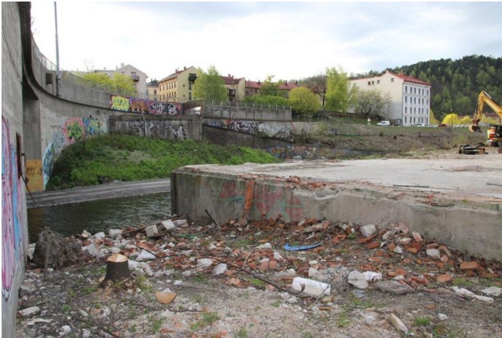
Figur 73. Området mellom Bispegata Bro og grunnmuren til Borgen. Moderne masser lå over laftekonstruksjonen. Foto mot øst (Cf34987_NIKU_0012).
