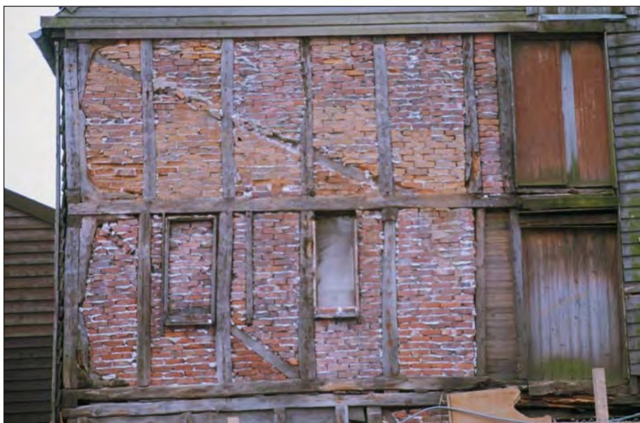
Figur 7. Sjøhus med utmurt bindingsverk som brannbeskyttelse, ca. 1860. Verksгатen i Stavanger. Foto: HS
