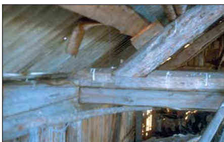
Figur 5. Brygge Myklebostad. Overgang vegg/tak. Foto: GJ
