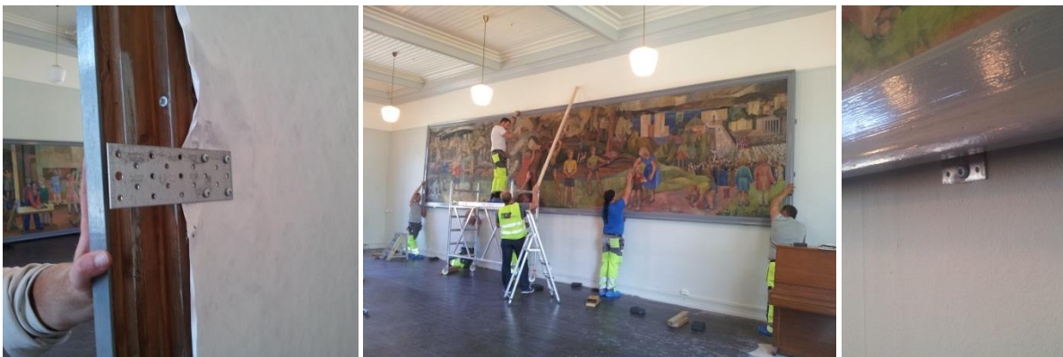
Remontering i samlingssalen på Møllergata skole. Beslag monteres til baksiden av pynterammene og skrues fast i veggen. Foto: Karen Mengshoel, august 2014
