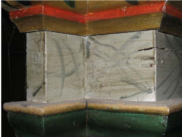
Foto 16: Detalj fra øvre side mot øst (venstre side). Fernissen er tidligere påført ujevnt på arkitekturelementene. Den misfargede fernissen gir altertavlen et uryddig utseende. Før rensing.
