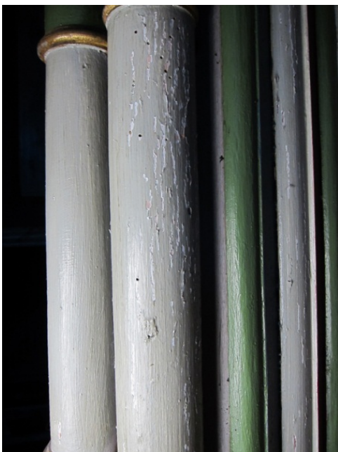
Foto 31: Søylene til venstre for fag 3 hadde mye løs maling og avskallinger.
