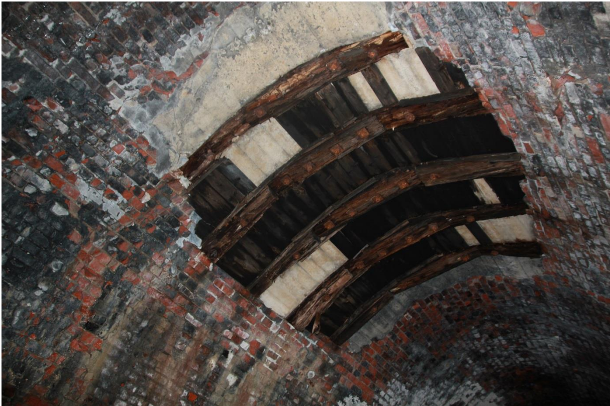
Foto: Løken tunnel. Nedrast parti i taket på hvelvet rett på innsiden av nordre tunnelmunning.
