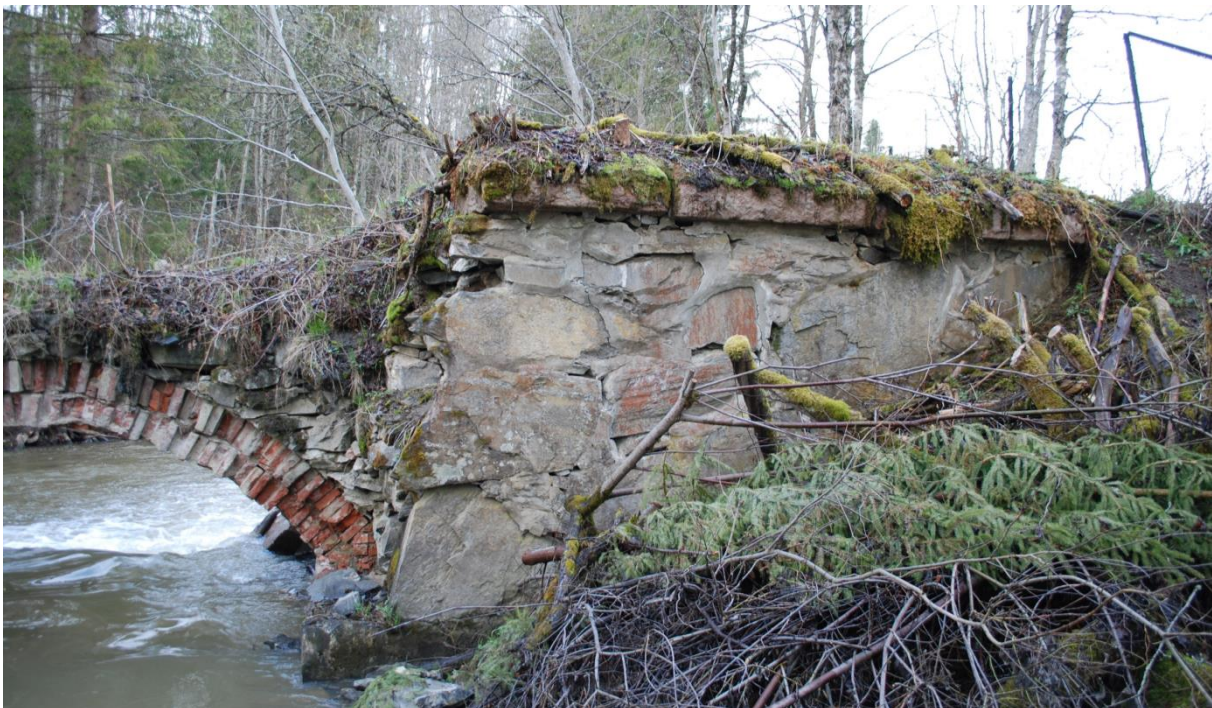
Foto: Bro II før rekonstruksjon, i mai 2013. Brokaret på nordsiden er relativt intakt, men bare deler av hvelvet står. Foto: NIKU v/AC Flyen
