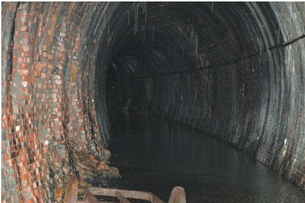
Foto: Løken tunnel. I 2006 var det mye vann i tunnelen. Foto: NIKU v/L. Mydland
