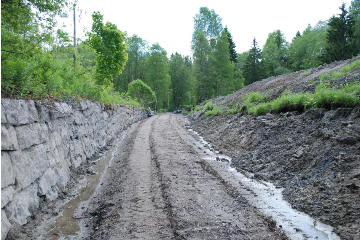
Foto: Under arbeid med avdekking av jernbanetraséen i juni 2013. Foto: NIKU v/AC Flyen
