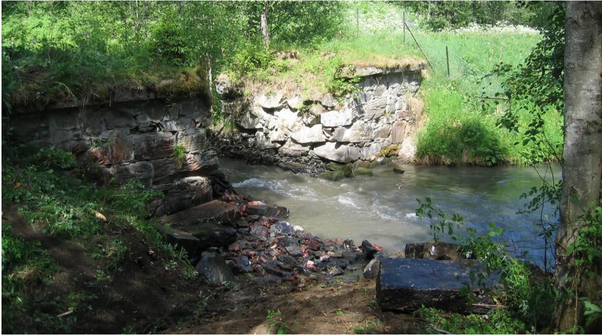
Foto: Bro III og elveløpet etter at masse er fjernet i 2009. Vannmassene hadde betydelig høyere hastighet etter opprensingen. Til høyre i bildet, oppe på land, vises en av de flate tilhuggede granittsteine med innhogget dryppnese som ble funnet i elven under opprensingen. Foto: AC Flyen, NIKU
