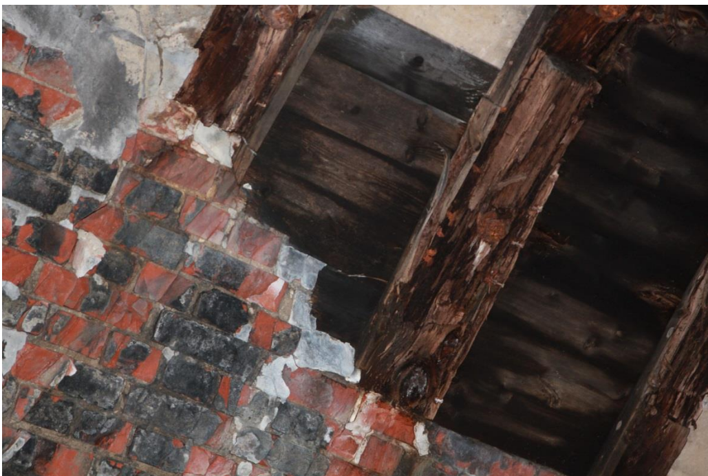
Foto: Løken tunnel. Detalj av taket i tunnelen ved nordre utgang i april 2015. Foto: NIKU v/AC Flyen
