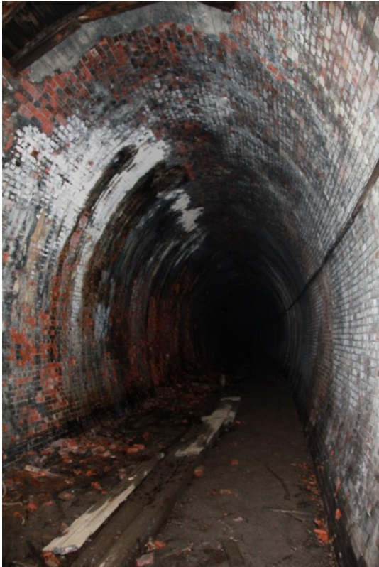
Foto: Løken tunnel. I 2015 var det tørt i tunnelen ved nordre utgang. Foto tatt i april 2015. Foto: NIKU v/AC Flyen
