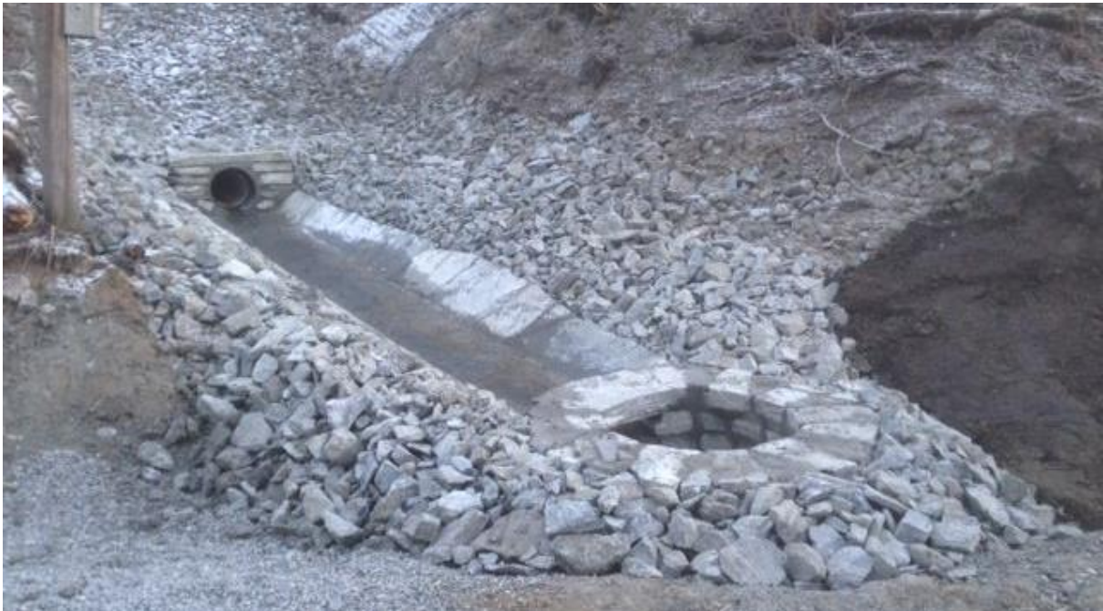
Foto: Vantrappen fra stikkrenna under Hagaveien og ned til kum ved jernbanetraséen like syd for søndre tunnelåpning. Arbeidet ble utført av Bakken og Magnussen AS. Terrenget er bearbeidet og jord lagt tilbake etter dette foto. Foto: NIKU /v AC Flyen.
